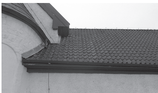
Plåtanslutning mot absid före åtgärd.
