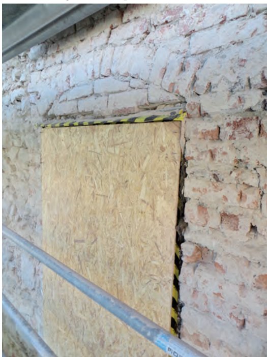
Nedan: Fönster på baksidan med valv av tegelstenar, vilket indikerar att det tillkommit efter 1785 års brand. Nedan till höger: Fönster på baksidan invid takfoten.
