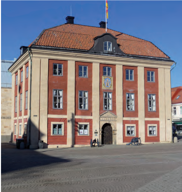
Gamla rådhuset inför arbetena. Fasaden hade ett tydligt slitage och dessutom kulörvariationer efter sekundär bättringsmålning.
