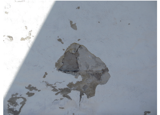
Putsskada på tornets södra fasad. Underliggande puts-skikt av olika sammansättning, det mörka till vänster är troligen ett cementhaltigt bruk.
