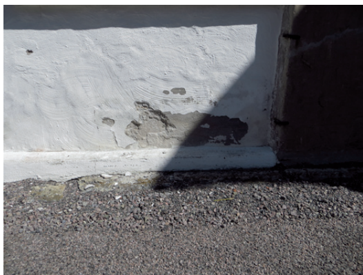
Putsskada på södra fasaden.
