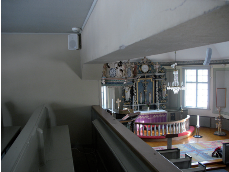
Rökdetektorn i taket på norra sidoläktaren.
