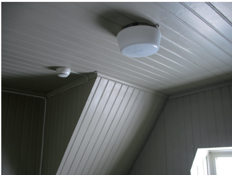
Rökdetektorn i trapphuset i tornet.
