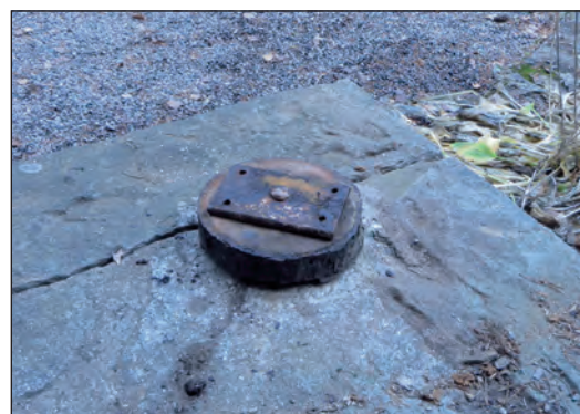
Kolonnerna stod på en cementklack omgiven av en järnring. En gängtapp med platta hade skruvats fast i kolonnbottnen, vilken var ingjuten i klacken. Denna stod i princip löst på golvet.
