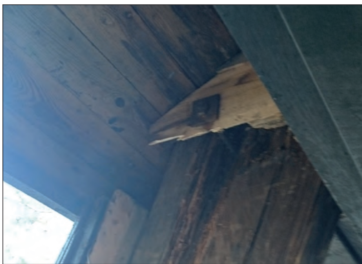
Den mittersta snedsträvan åt väster hade en kraftig rötskada i anslutning till paviljongtaket.
