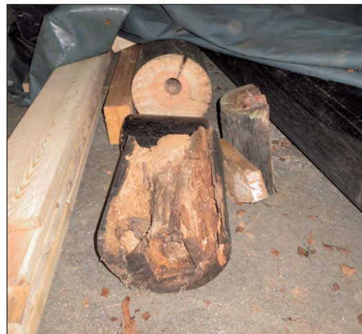
En av de rötskadade kolonnerna efter rivning. Kolonnerna hade kärnborrats, sannolikt för att minska inre spänningar. Detta utfördes även på de nya kolonnerna.
