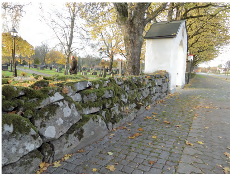
Muren i väster, söder om stigluckan, lutade inåt före åtgärd.
