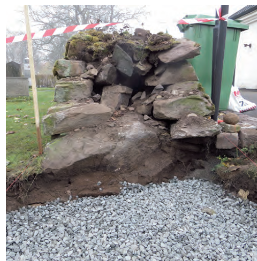
Flera av murarna hade hålrum i sin kärna, här muren i sydväst.
