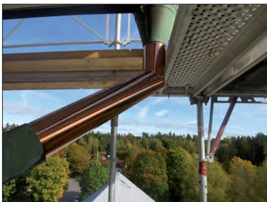
Tornets kopparstuprör läckte i anslutningen till krökarna. Därför byttes krökarna ut mot nya.
