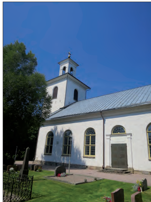
Ommålningen av kyrkans plåttak var mycket angelägen eftersom färgen på södra takfallet var fullständigt avflagnad.
