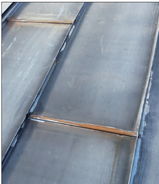
Avflagnings av färg i anslutning till falsarna hade lett till korrosionsangrepp. På nordsidan hade färgen bleknat vilket gav kyrkan ett sjangserat utseende.
