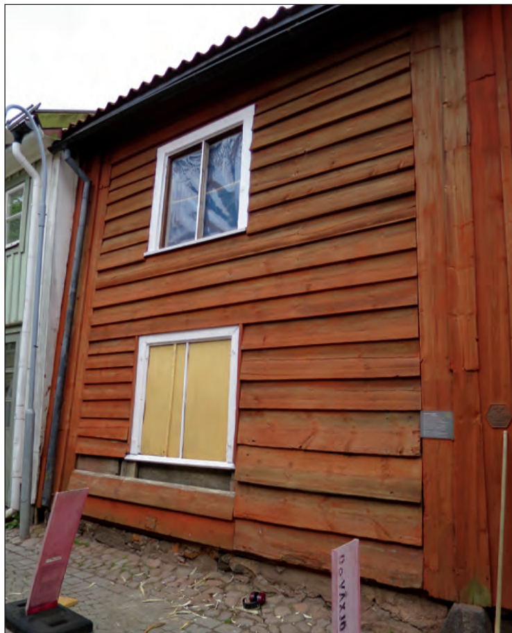
Panelen mot bakgatan var av hög ålder och bidrar i hög grad till ladugårdens ålderdomliga utseende. Därför var man mycket restriktiv med lagningar i panelen. Brädan som ersattes tillhörde en sentida lagning.
