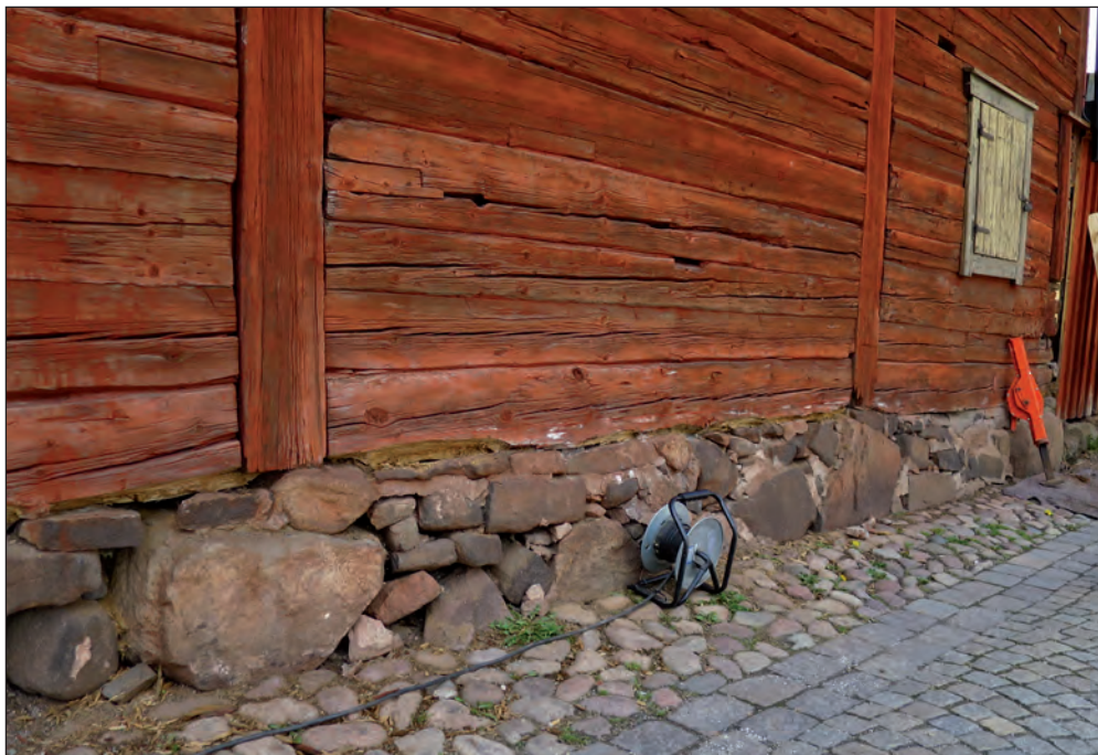
Bodlängans skiftesverksfasad mot Arndt Byggmästares gata. Variationen i timmerfasaden, mindre skador och sentida slarvigt utförda lagningar, ger karaktäristiskt utseende för enklare uthusbyggnader. Mot grunden förekommer ytliga rötskador i syllen.
