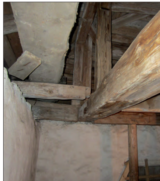
Takstolen till tornetaket var redan då den byggdes felaktigt konstruerad. Troligen har nedböjningen i bindbjälkarna uppstått ganska snart efter byggtiden och då åtgärdats genom stöttor placerade på underliggande bjälklag.
