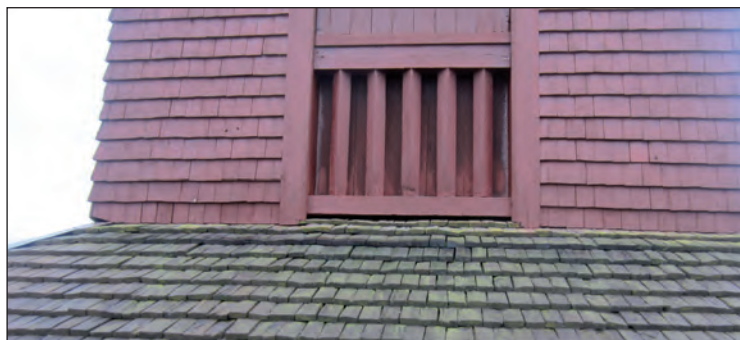
Detalj av torntaket. Inskottsplåtar som annars skyddar mot inträngande fukt saknas både vid fasaden och den luckförsedda öppningen.
