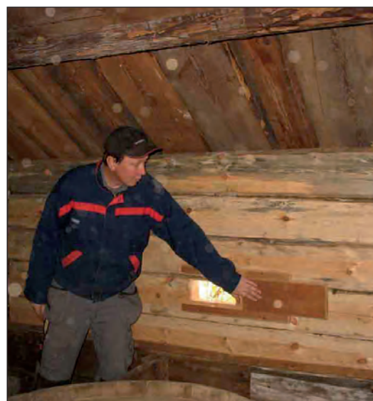
Omkring bryggdörren hade delar av murverket rämnat.
