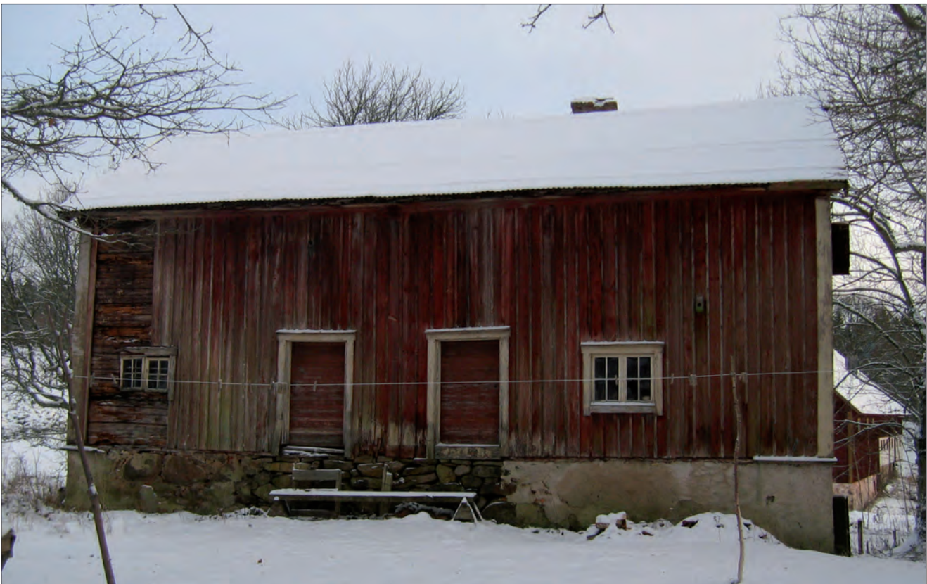
Fasaden mot innergården 2005. Den kraftiga skadan i den norra delen, orsakad av takläckaget, omfattar såväl timmerväggen, fasadpanelen som visthusbodens fönster. Skadorna i syllan kan skönjas som en sättnings i anslutning till den vänstra boddörren. Träbryggan har helt försvunnit sedan 1990-talet. Under träbryggan verkar sockeln inte ha varit putsad. Taket har sedan ett år tillbaka en skyddtäckning av plåt. Foto: Ulrika Olsson, 2005 JLM.
