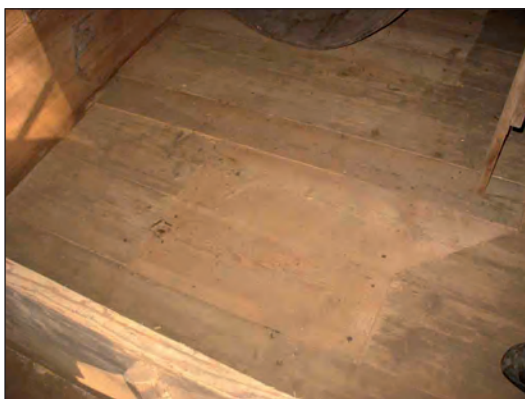
Rötskador i sädesmagasinets golv lagades i lokalt med äldre golvplank.
