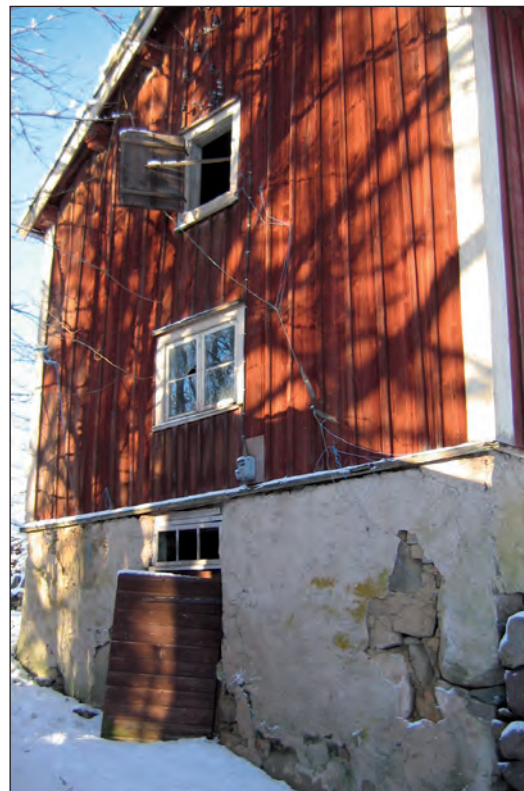
Trots stödmuren har källarmuren kalvat ut åt öster, vilket orsakat sprickbildning och putsbortfall på södra sidan. Omkring bryggdörren har delar av murverket rämnat. Fläckvisa bompartier och putsbortfall finns på hela sockeln främst i anslutning till marken och under dropplisten. Foto: Ulrika Olsson 2005 JLM.
