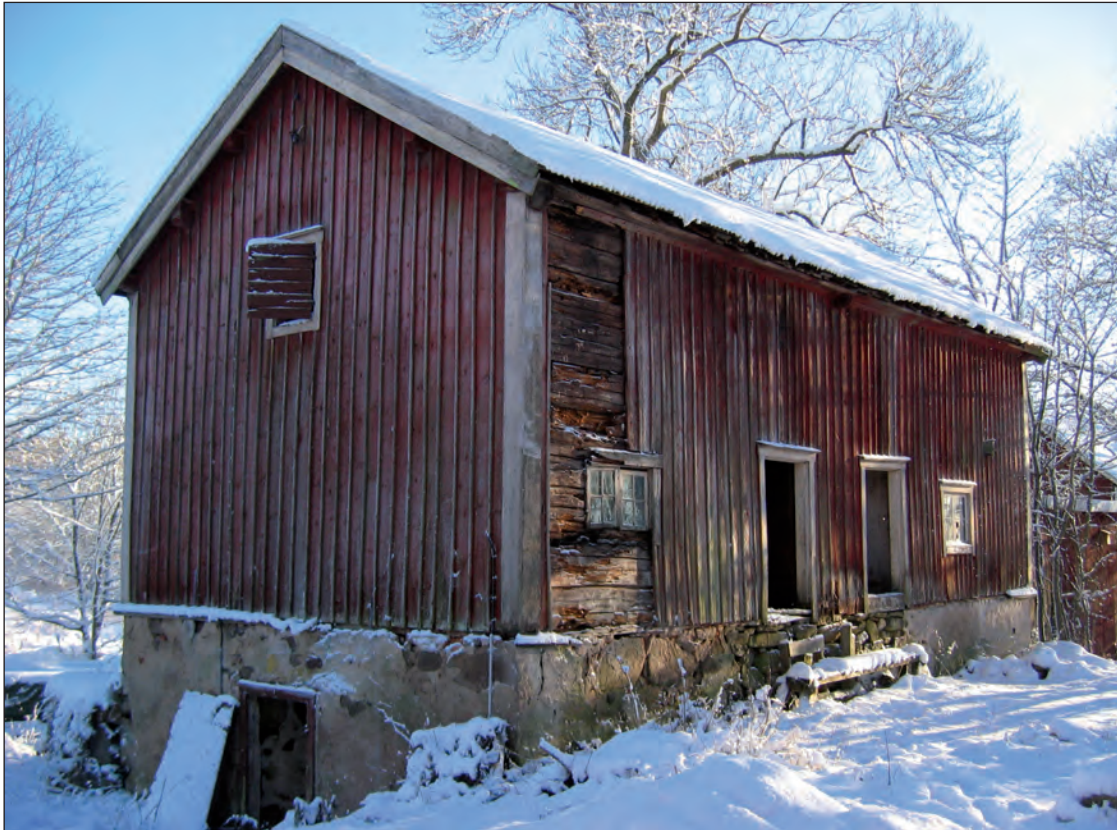
Ett takläckage som pågått under mycket lång tid hade orsakat kraftiga skador i byggnadens västra timmervägg och fasad. Foto: Ulrika Olsson 2005, JLM.
