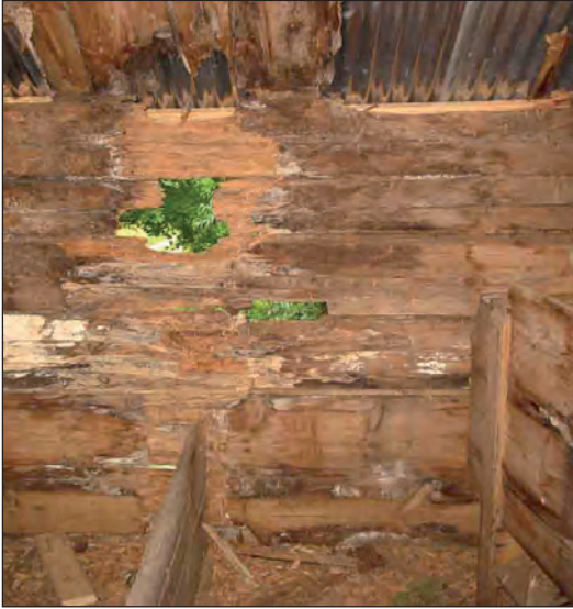
Skadorna är mycket omfattande i magasinets sydöstra del, med stora håligheter i takbottenpanel och timmervägg.
