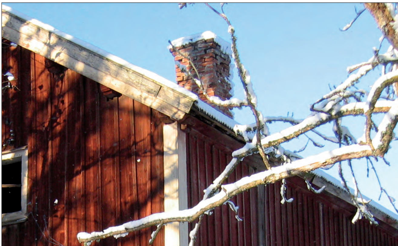
På den södra gaveln kvarstår en äldre kilsågad locklistpanel medan övriga fasader har en panel av 1930-40-talstyp. Synliga skador finns i takfoten och på fasaden orsakade av takläckaget i anslutning till skorstenen. Takåsar och remstycken har profilhuggna ändar vid gavlarna. Vindskivorna är dubbla med ett nedre avrundat hörn. Skorstenen är murad av tegel i skorstensförband med profilerat krön. Foto: Ulrika Olsson 2005, JLM.
