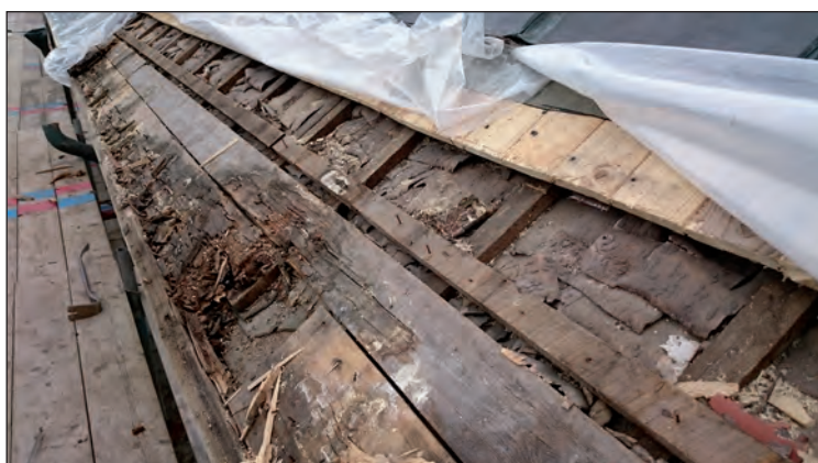
Rötskadorna i takfoten berörde enbart brädor som spiakts ovanpå den äldre nävertäckningen på 1960-talet. Skadade brädor ersattes med nya.
