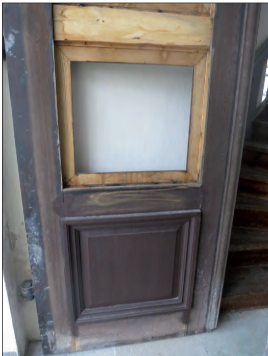
Kyrkans portar bestod av sammanlimmade delar. Västporten på bilden kunde lätt tas isär vid renoveringen.
