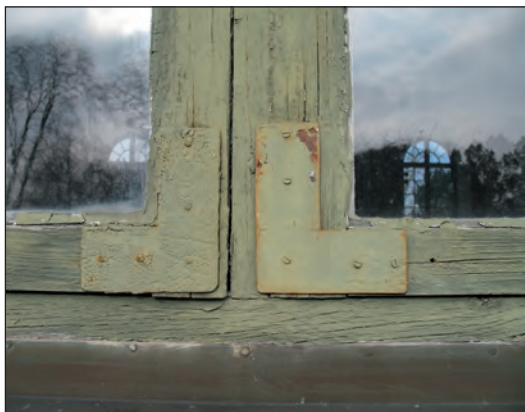
Fönsterbågarnas enkla hörnbeslag av smidesplåt hade i enstaka lägen ersatts med plåtbeslag i felaktiga mått och med spårskruv. Kittfalerna var ovanligt grunda.
