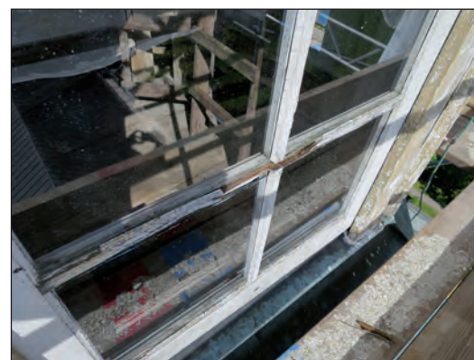
Fönstren från 1998 hade omfattande rötskador, något som bidragit till att fukt trängt in och orsaka mosspåväxt.
