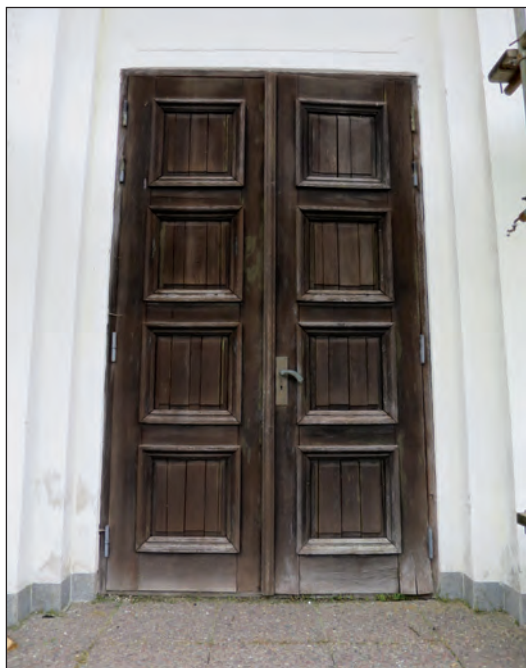
Kyrkans tre portar har kraftiga uttorkningsskador i spegelfyllningarna och rötskador i utvändig träbeklädnad främst i nederkanterna.
