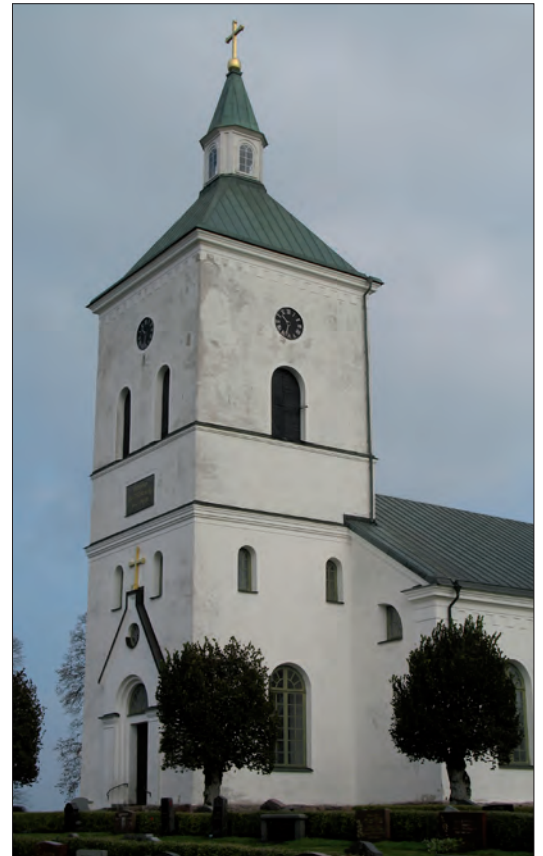
Tornet har putsskador och äldre misspyrdande lagningar. Dessutom är fasadfärgen kraftigt vittrad och angripen av rödalger.
