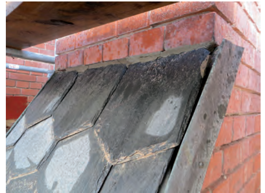
Uptill fanns bruksfogar, som delvis var skadade.
