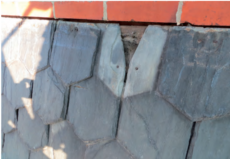
Skifferplattorna hade börjat lossna på avsatser och kontreforer.
