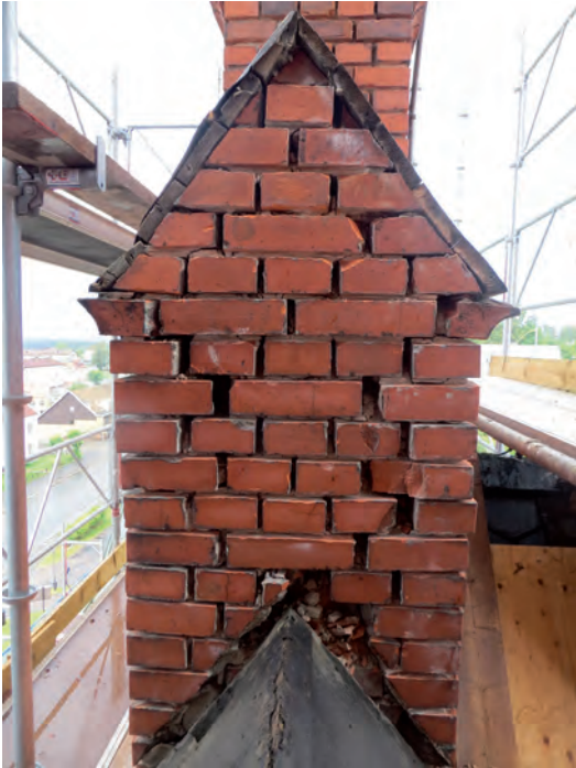
Kraftigt skadad trappgavel med risk för ras.
