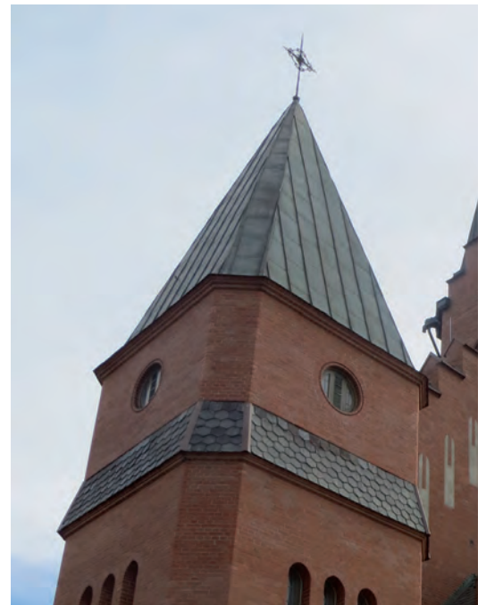
Fogen som avslutar skifferläggningen upptill gjordes av svartgrå mjukfog, vilken inte blev iögonfallande.
