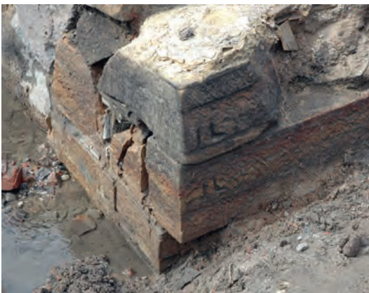
FIGUR 77. Sandstenskvader i det nordöstra hörnet av bastion Carolus. Notera hur den mjuka stenen spruckit på grund av de sättningar som skadat byggnaden.
