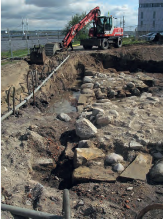
FIGUR 76. Östra fasen på bastion Carolus frilagd. Spåren efter ett förödande ras syntes i fasaden vars stenbeklädning reparerats högst osakkunnigt. Raset bör ha inträffat under tidigt 1700-tal då fästningens underhåll var eftersatt. Foto från norr.
