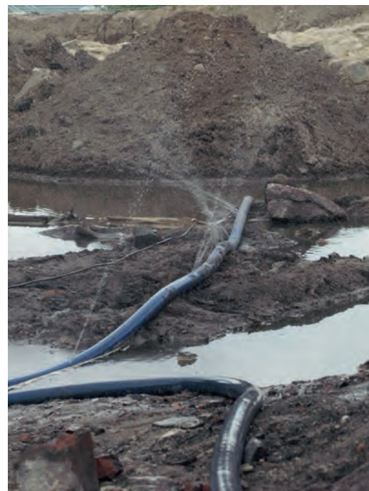
FIGUR 27. Pumpsystemets svaghet - trasiga slangar och läckande kopplingar...
