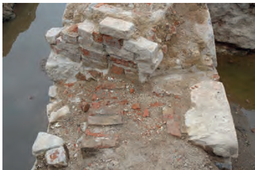
FIGUR 101. Utfallportens tegelklädd öppning. Notera hur öppningen smalnar av mot murens utsida. Lägg också märke till att tegelförskalkningen inte murats i förband. Exempel på osakkunnet arbete? Foto från öst.
