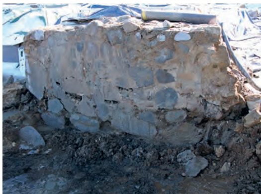
FIGUR 110. Den genomsågade kurtinmuren drygt en meter norr om bastion Carolus. Notera hur lite kalkbruk som finns i murens djupare liggande delar. Foto från norr.
