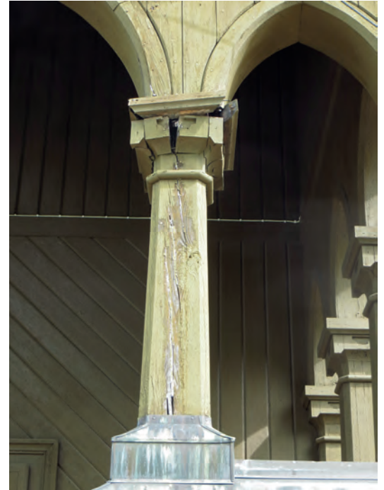
En av pelarna vid den södra entrén hade synliga skador.
