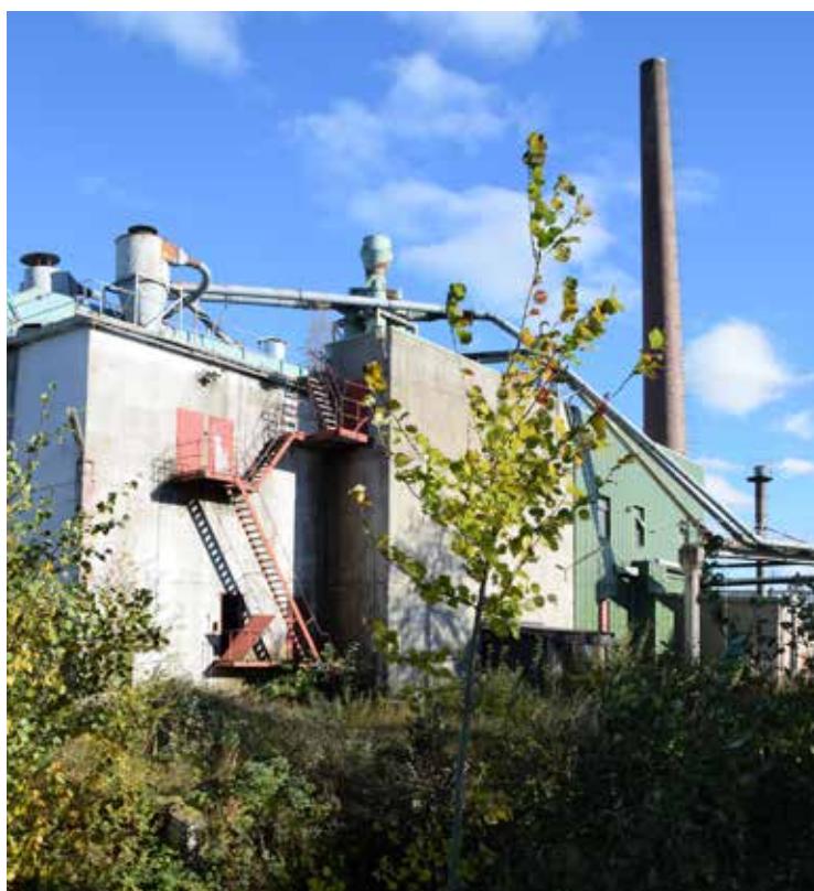
Panncentralen från väster, längst till vänster flissilon.
