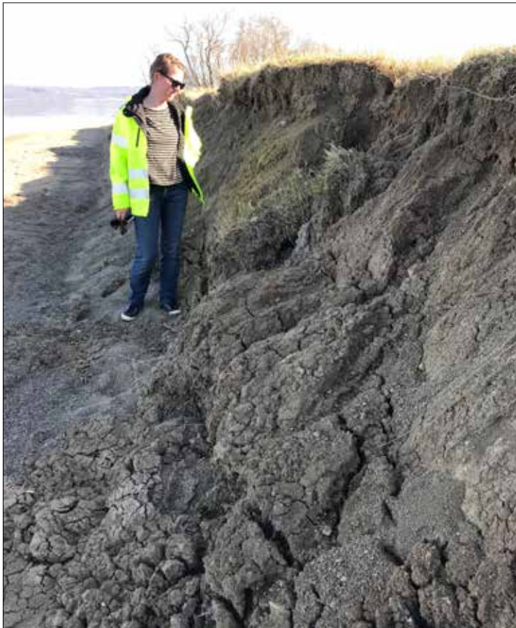
Figur 2. Lotten Haglund vid rasbranten som hade kraftiga erosionskador vid besöket i april 2018.
