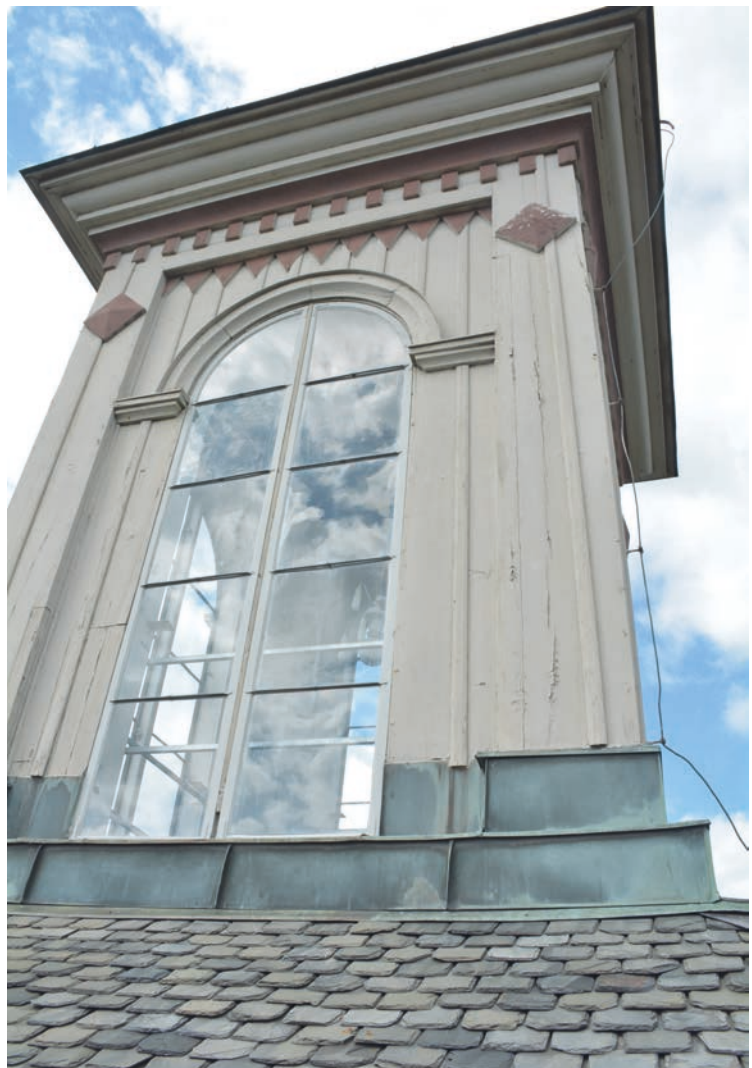
Lanterninen före åtgärd.
