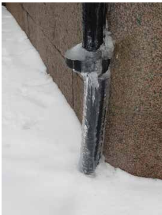
Ovan: Stuprör troligen igenfruset. Ovan till höger: Parti av sockeln av sten där fogningen var bristfällig.
