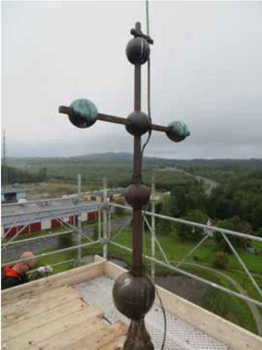
Ovan: Spirans krönande kors inför restaurering. Ovan till höger: Deformerat klot som läckte in vatten.
