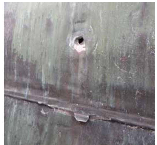
Den befintliga plåten på spiran hade omfattande skador. Här syns spår efter ett tidigare fäste för en demonterad åskledare.
