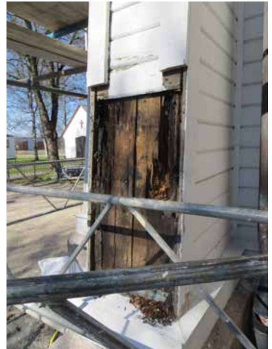
I tornets snedsträvor, bakom panelen upptäcktes rötskador.
