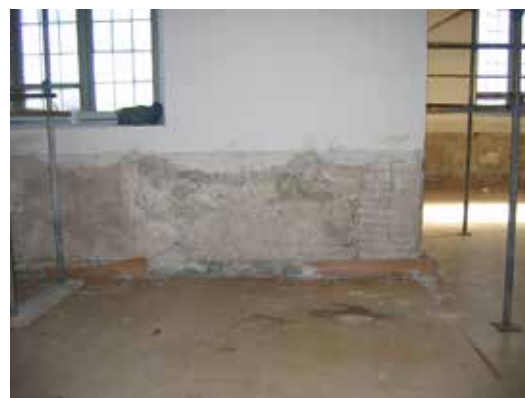
Muren i vinkeln mellan koret och södra korsarmen var lagad med kalksandsten.
