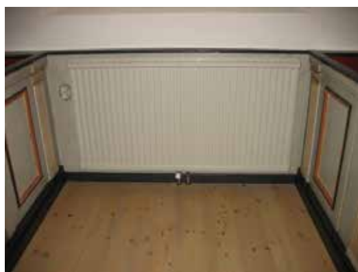
Bänkradiatorerna kompletterades med ett antal vägghängda radiatorer för att få rätt effekt. Här i södra korsarmen.
