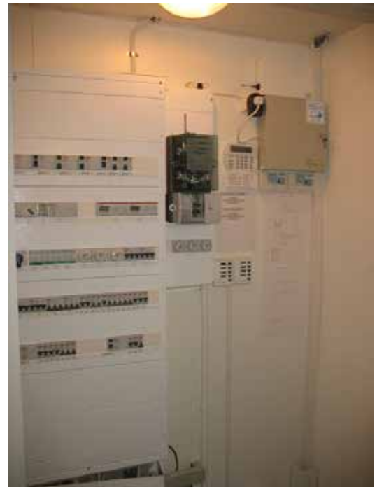
En ny elcentral inrättades i norra korsarmen.
