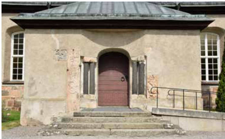
Trappan vid sidoportalen före åtgärd.
