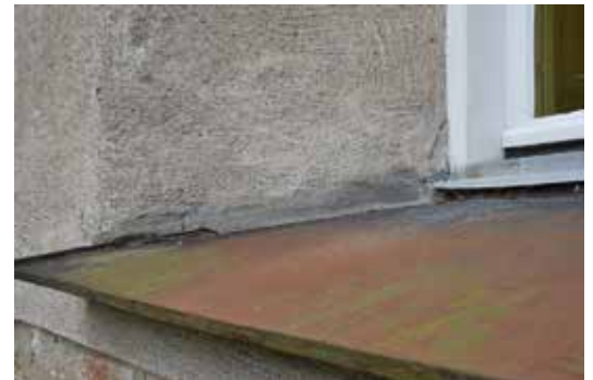
En av solbänkarna före åtgärd, med en tidigare lagning i anslutning mot solbänken.
