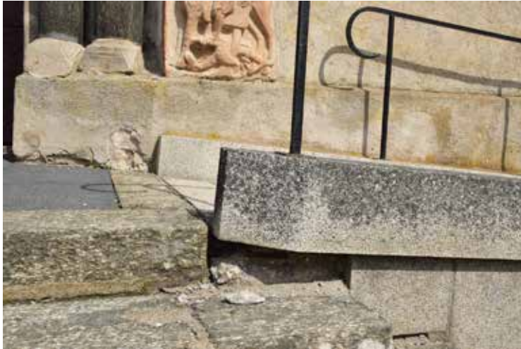
Detalj av skador vid rampen före åtgärd.
