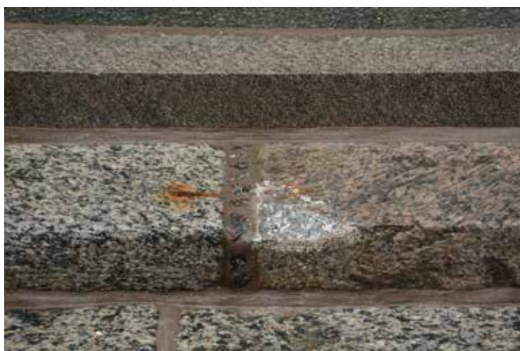
Då lagningsbruket blev för ljust togs lagningen bort, foto från slutbesiktningen den 4 oktober 2017.
