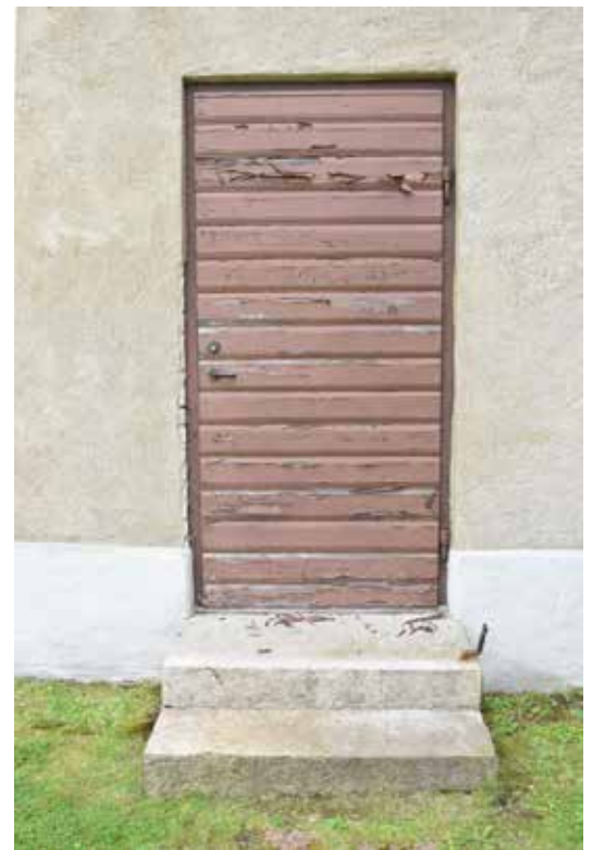
Dörren till sakristian var den dörr som var i sämst skick före åtgärd. Även den flagade på ett sätt som indikerade att den var målad med alkydolfärg.
