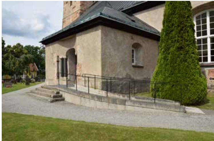
Rampen före åtgärd.
