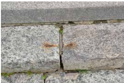
Detalj av trappan vid västra entrén, dubben har rostade och stegen glider isär.
