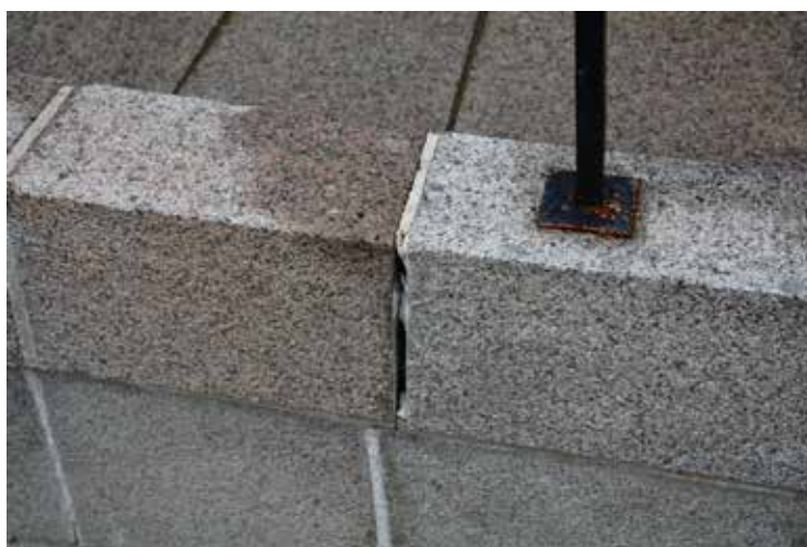
Rampen vid efterbesiktningen i september 2018, flera av fogarna hade fallit ur.
