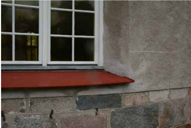
En av solbänkarna med den rostskyddsbehandling som sedan blästrades bort och ersattes med en traditionell behandling.
