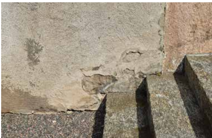
Skador på sockeln vid sydportalen före åtgärd,
