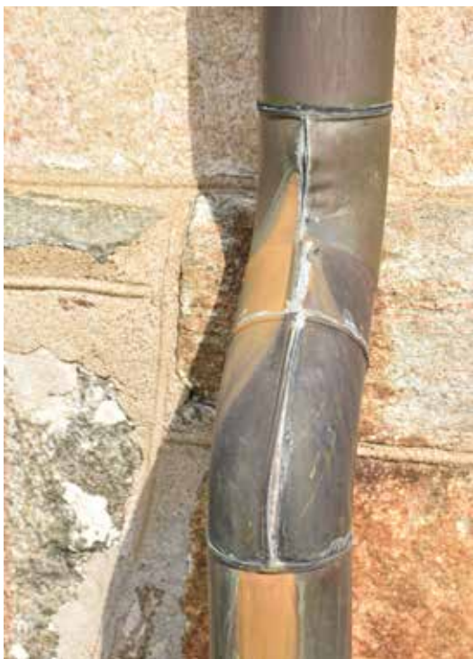
Ett av de skadade stuprören med frostsprängda fogar.
