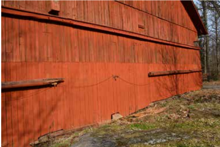
Kolladan före åtgärd, delar av den nedre gördelbalken hade rämnat.
