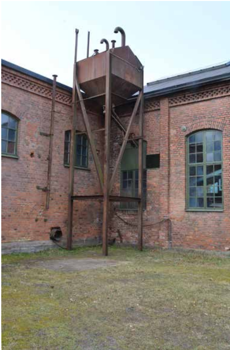
Sandbehållaren före åtgärd.
