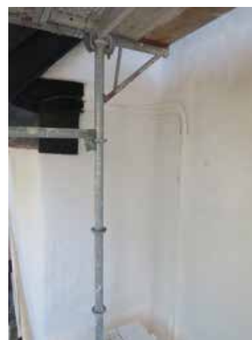
Inmålad kabel på tornets norra fasad.
