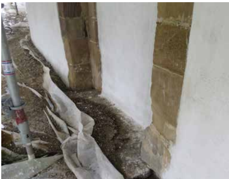
Färgstänk som uppstått på stenportalen vid avfärgningen.
