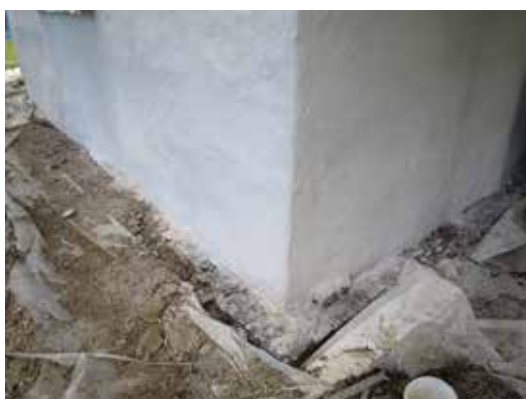
Putsen drogs ända ner under mark, utan en synlig skarpt markerad avslutning.
