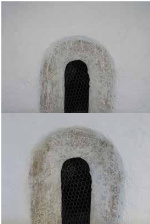
Tornets västra ljusglugg, före och efter det att rinningar av kalkfärg tagits bort av konservator.
