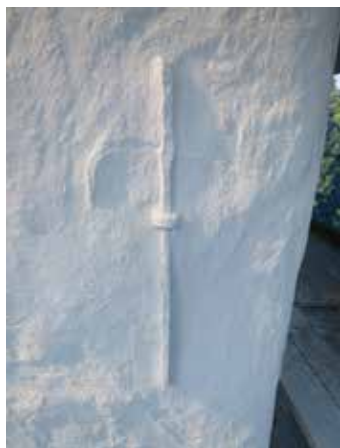
Tornets ankarjärn hade kalkades över av misstag. Detta korrigerades.
