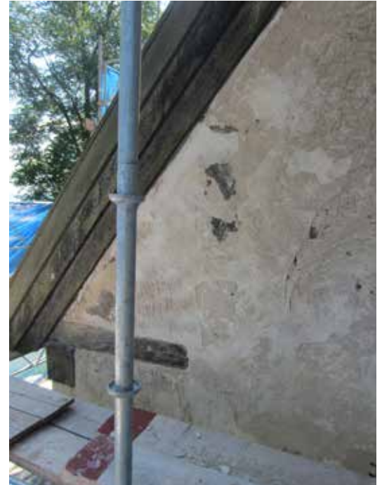
Tyvärr utfördes inte rengöringen med högtryckstvätt överallt med de krav på varsamhet som ställts. Här är ett parti av sakristians gavel med spår av mekanisk nötning som uppstått i putsen.
