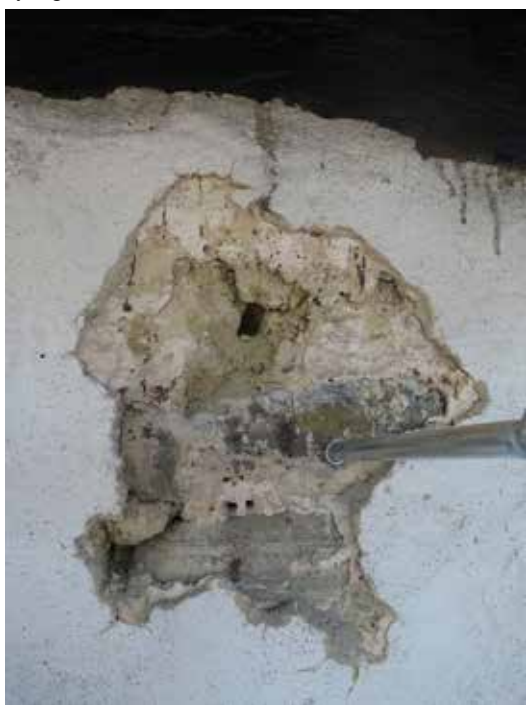
Oförsiktighet vid infästningen av ställningen ledde till skador i putsen.
