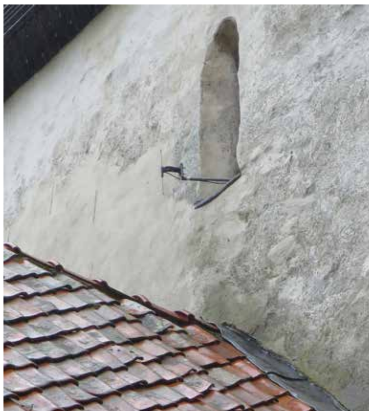
I anslutning till 1980-talets murverkslagningar vid tornets sydöstra hörn har putsen en avvikande slätare yta.
