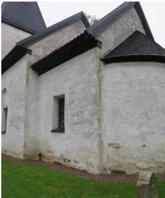
Generellt förekommer putsador längst ned på fasaderna. Den äldre putsen är angripen av gråalger.
