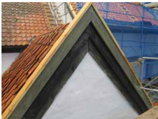
Samtliga vattbrädor på taken ersattes med nya av finsågad kärnfuru. De var något tjockare än tidigare och spikades med smidd spik.
