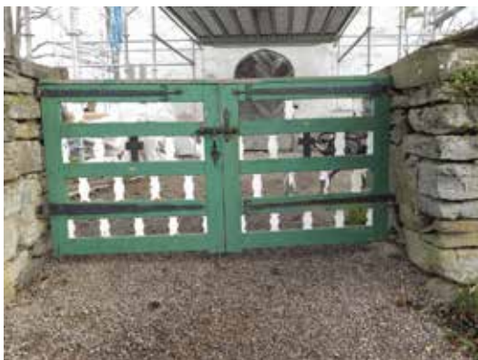
Grinden till kyrkogården, vilken ritats av arkitekt Göran Pauli 1922 har omfattande rötskador efter att den har målats med en tät akrylatfärg.
