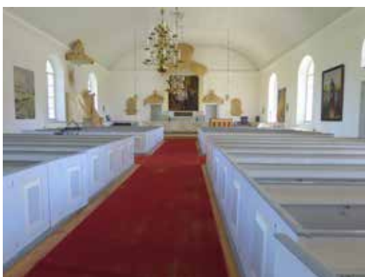
Kyrkorummet efter skyddstäckning av den känsliga inredningen. I samband med isoleringsarbetena på vinden föll en stor mängd sågspån ned.
