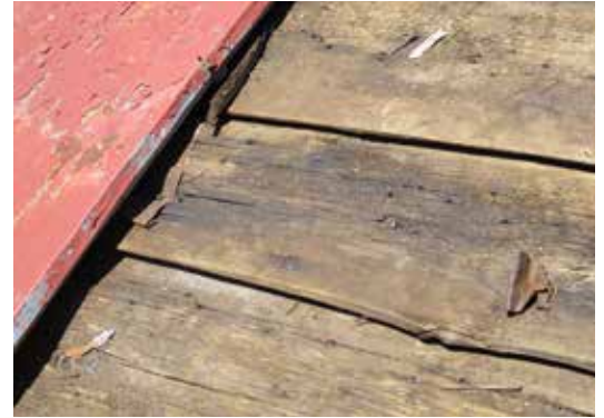
Fästbleck i svartplåt från plåttaket som kyrkan hade under perioden 1901–1952.
