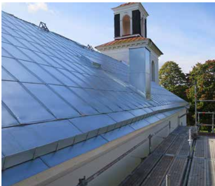
Den sentida skorstenen åt norr fick behållas eftersom oljepannan fortfarande är i bruk.
