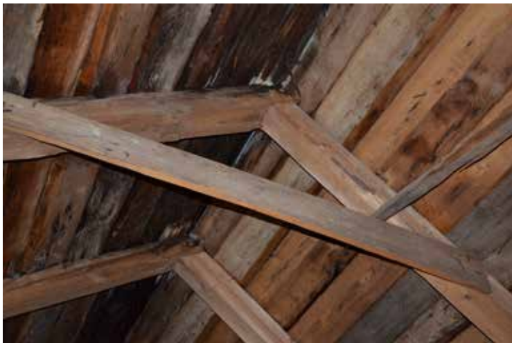
Takläckaget med röt- och mögelskador i taksvallens insida. Här i anslutning tillnocken.
