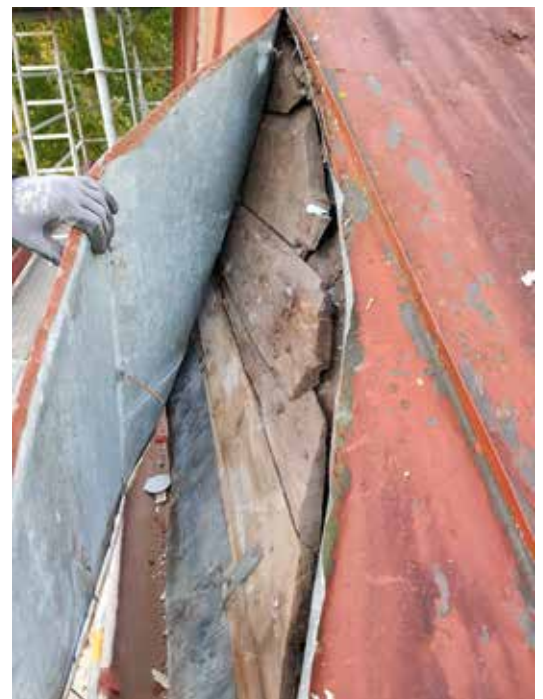
På långskeppets västra takfall fanns ingen spåntäckning bevarad.
