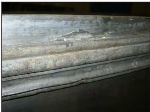
Måttliga korrosionsangrepp på långsidans övre kant. Foto: Cai Zetterström.
