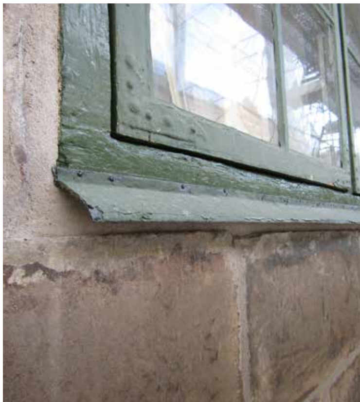
Återmonterat fönsterbleck där karmen målats, men bleckets målning återstår.
