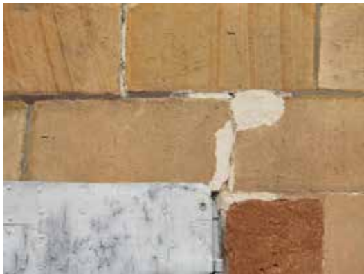
På Domstolsbyggnadens fasader finns många exempel på fogning som inte ger ett prydligt intryck.
