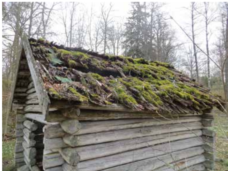
Taket var förfallet, hade hål och var kraftigt mossbevuxet.
