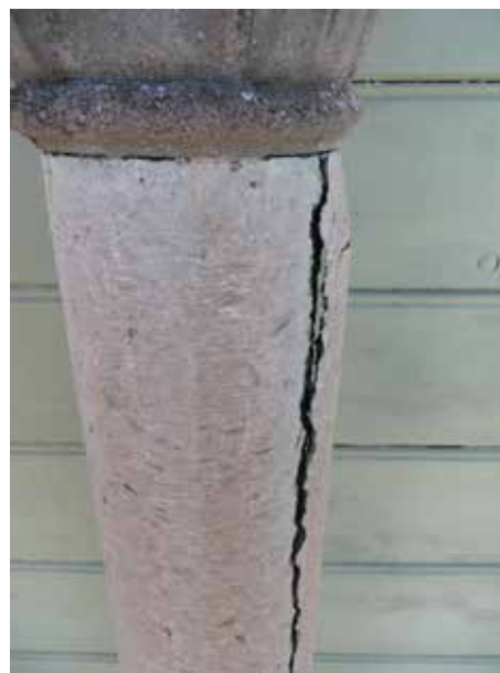
Klovspricka norra kolonnetten
