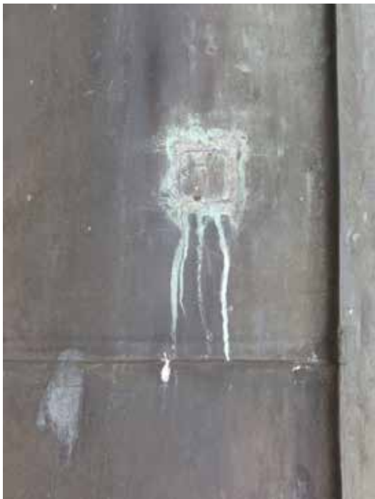
Flera av takets hål var sedan tidigare lagade med pålödda "lappar".
