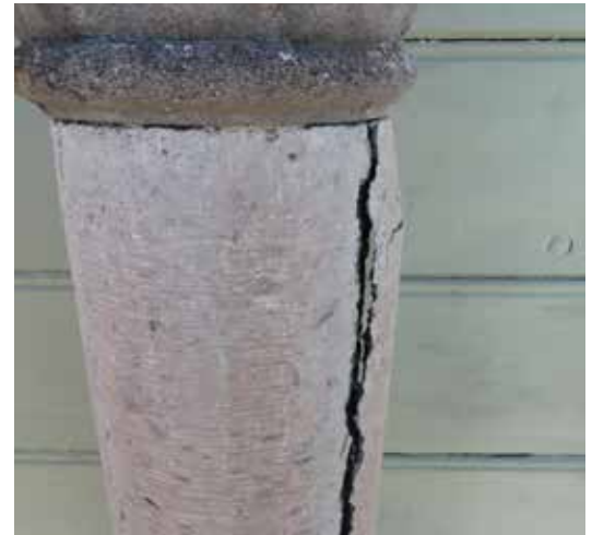
Ovan: Spricka i den norra kolonnetten.
