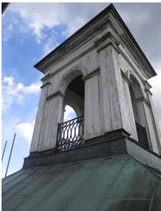
Färgen på lanterninen är kraftigt nedbruten. Hörnpilastrarnas baser har 1983 tagits bort och ersatts med anslutningsplåt av koppar.
