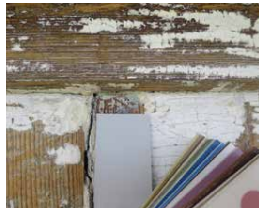
Spår av bevarad originalfärg på lanterninens fasad, sannolikt bottenfärgen i grått till marmoreringen.
