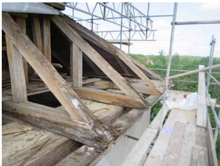
Två av takstolarna åt öster hade rötskador på ovansidan av högbenen och i bindbjälkarnas ändar.
