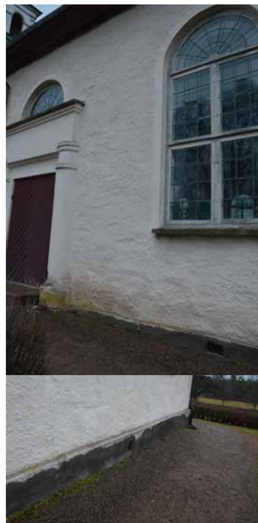
Kyrkans ursprungliga puts är i gott skick, däremot förekom skador på putssockeln.
