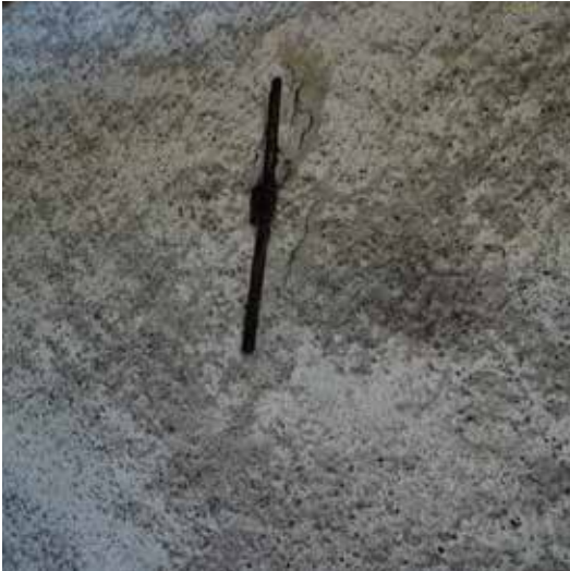
Parti av tornets fasad efter prov med JOS-blåstring. Redan före rengöring förekommer hög andel frilagd spritsten.
