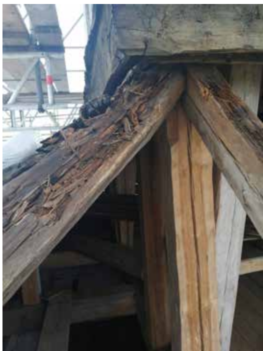
Långt gångna rötskador fanns även i vissa av högbenens övre delar.
