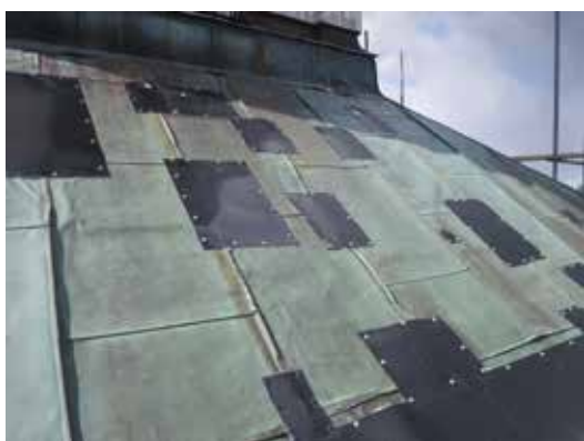
Torrtakets koppartäckning har omfattande skador åt öster. Skadorna har lagats provisoriskt.
