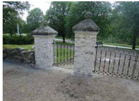
Den sentida skadade putsen på grindstolparna åt väster knackades ned in till murverket.
