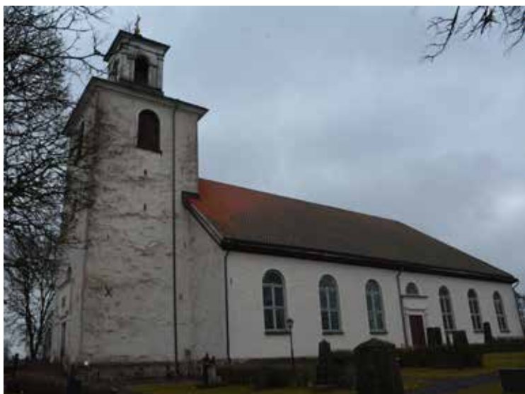
Kyrkan strax före restaureringen 2019. Fasaderna är, framför allt på tornet, kraftigt svärtade av rödalger och lavangrepp. Färgen på lanterninen är till stor del bortvittrad.
