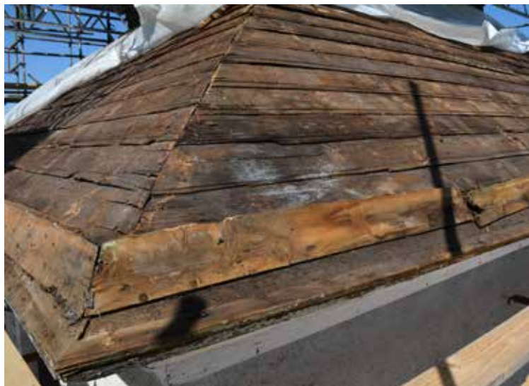
Takbottenpanelen både på torn- och lanternintaket bestod av äldre takbrädor med typiska spår för vattenavledning, sannolikt hämtade från äldre byggnad med torvtak.
