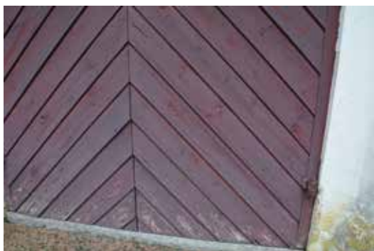
Den sekundära panelen på kyrkans södra port är sprucken och rötskadad i de nedre delarna.
