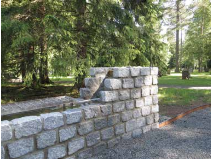
Rännan med blomgaller, från delbesiktning 2016.
