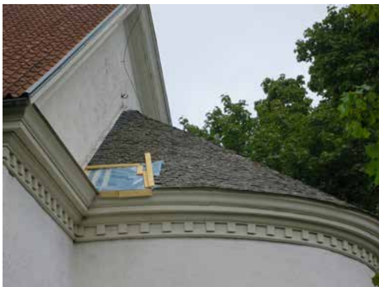
Omläggningen av skiffertaket föranleddes av ett läckage på den södra sidan.
