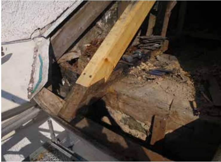
Högbenet sammanfogades med stickbjälken lika tidigare utförande, med urjackning och spikning med grov smidd spik. Notera den allvarliga rötskadan i remstycket, med en stor hålighet.
