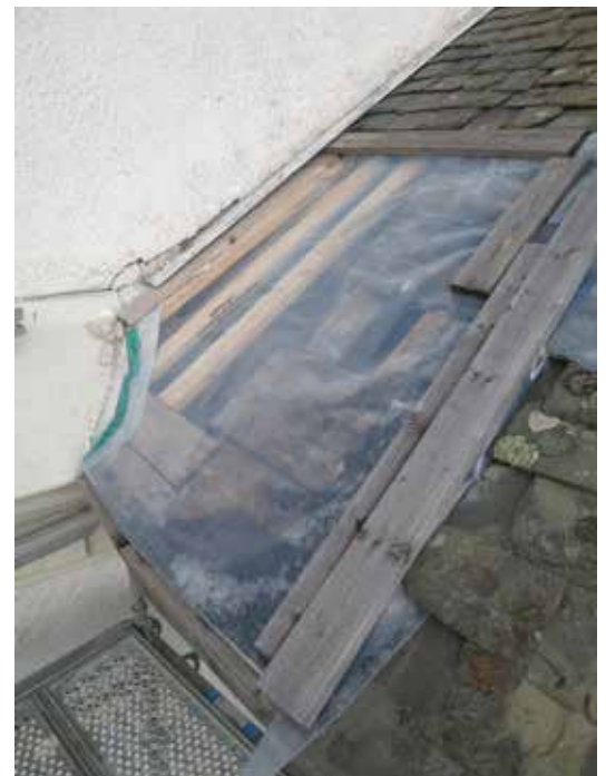
Uppbrutet parti åt söder där läckage förekom.
