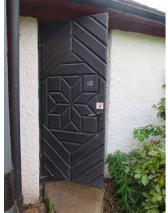
Ytterdörren till sakristian före ommålning. Ingången tillkom liksom dörren 1953. Notera även hänggränsan infäst med krokar i takfoten. Foto taget 2018, JLM.
