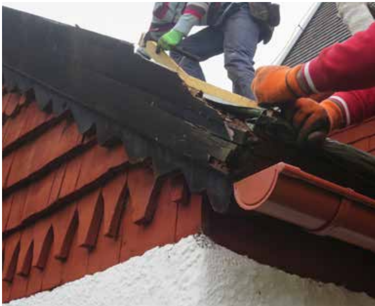
Detalj av sakristians vindskivor före åtgärd.
