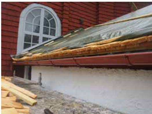
Nedersta vid takfoten lades dubbla skift spån. Däremot sattes ingen luftningslist under spånen. Nedersta brädan i taksvallen åt öster ersattes med en ny.
