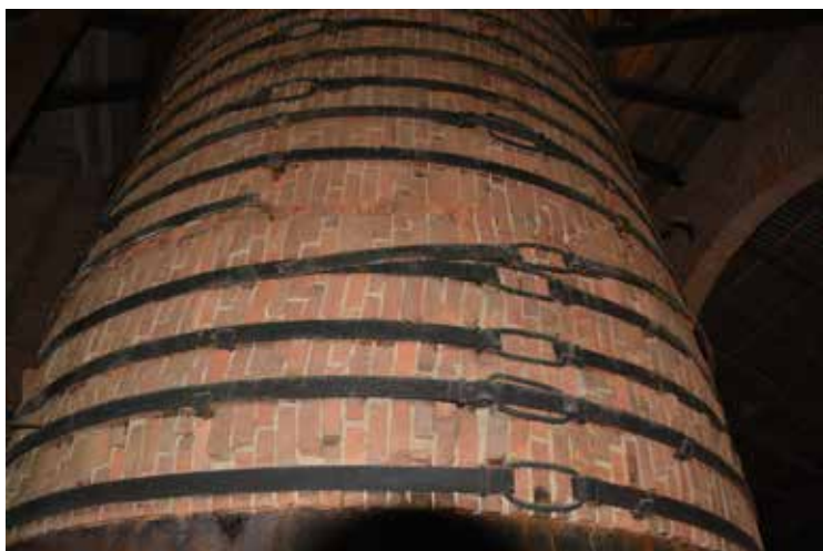
Masugnen före åtgärd. Dragjärnet mitt i bild har gått av och kasat ner då även det inmurade fästet var sönderrostat.
