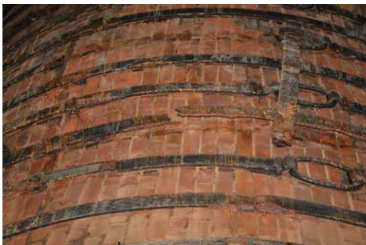
Masugnen före åtgärd. Mitt i bild syns ett avrostat dragjärn och i bildens överkant ytterligare ett avrostat järn som hänger ner.
