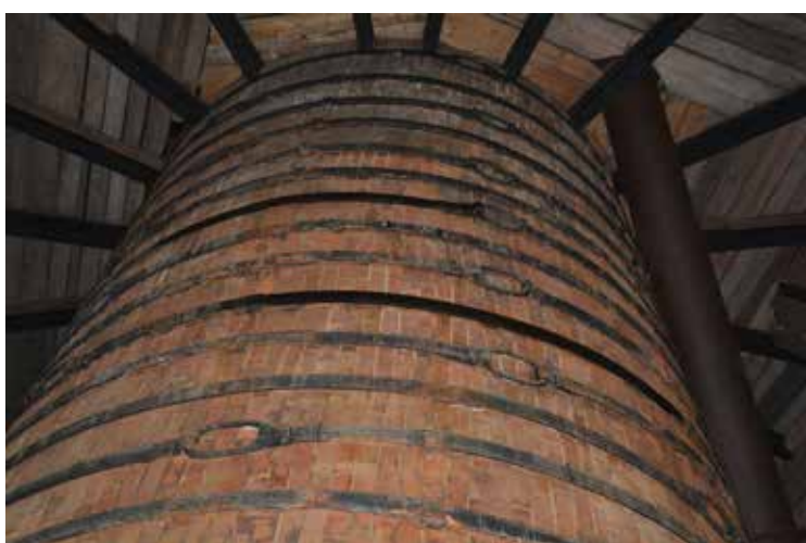
De två lagade dragjärnen mot masugns framsida (i bild band 5 och 8 nedifrån räknat).
