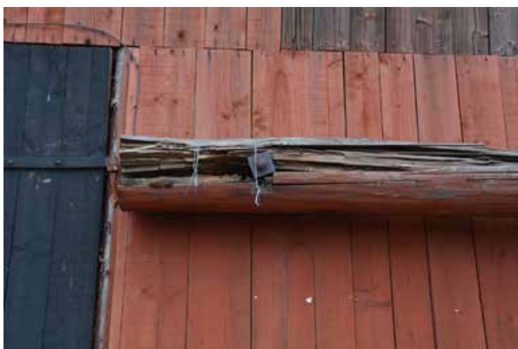
Kolladan före åtgärd, vissa av balkarna var i riktigt dåligt skick och hade fått säkras inför arbetena.
