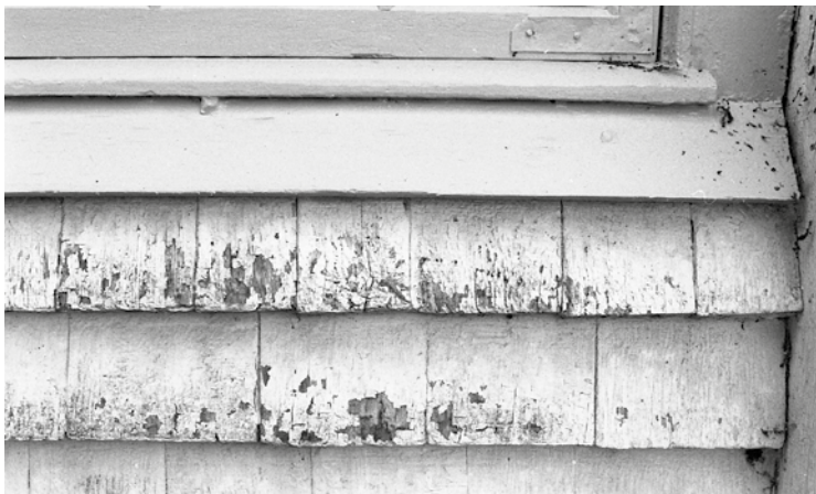
Detalj av den linoljemålade spånfasaden före åtgärd, partiellt var färgen kraftigt flagad.
