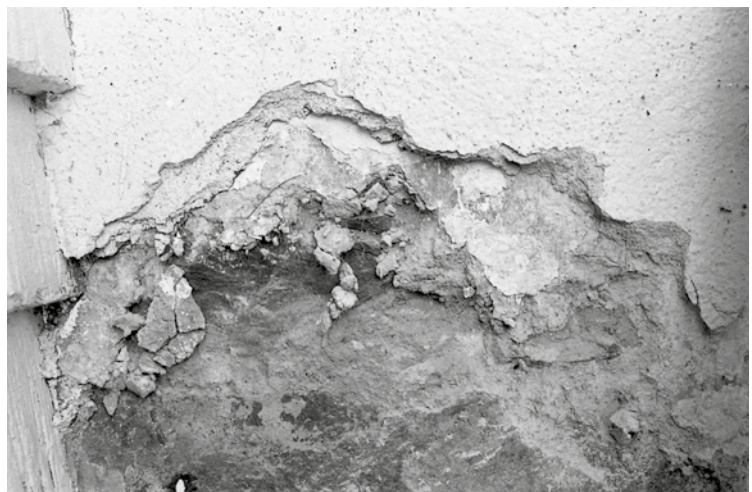
Äldre putsskikt framkom vid nedknackningen av skadad puts på tornets nedre del.
