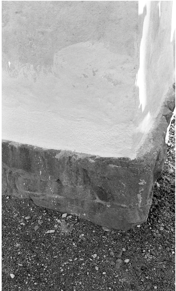
Detalj tornets västra fasad. Ballasten i lagningsbruket är något grövre än omgivande.
