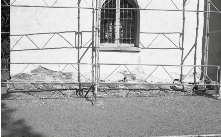
Nedknackad puts på tornets nordvästra fasad.
