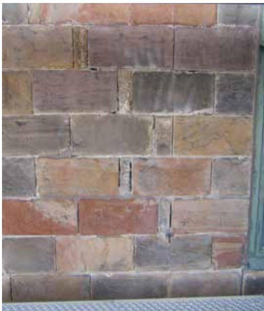
Väggparti där större delen av fogarna rensats.
