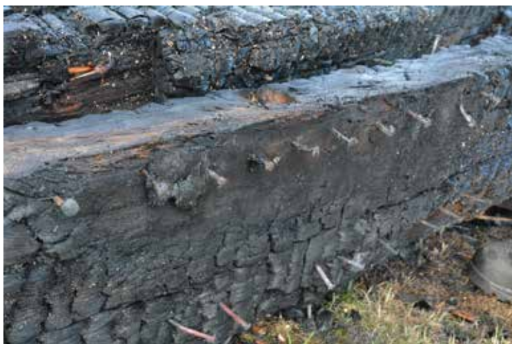
De täta spikraderna efter den ursprungliga spåntäckningen.
