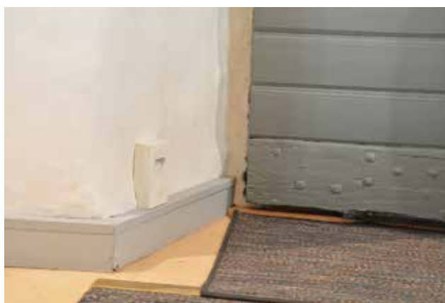
Nödbelysning monterades vid samtliga dörrar.
