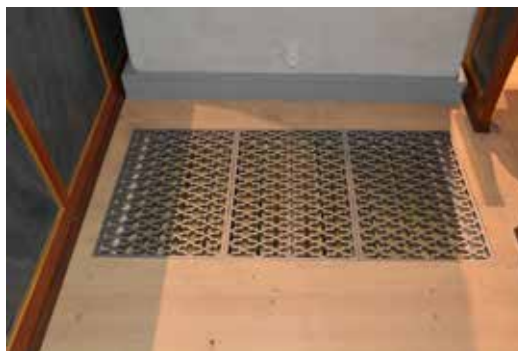
Inluften tas in via lite större galler som är placerade i valvet mellan korsarmarna och långhuset.
