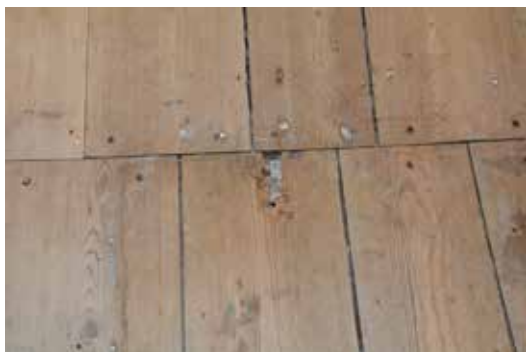
Under heltäckningsmattan i tornrummet fanns ett äldre skurgolv bevarat. Golvet hade smärre skador.
