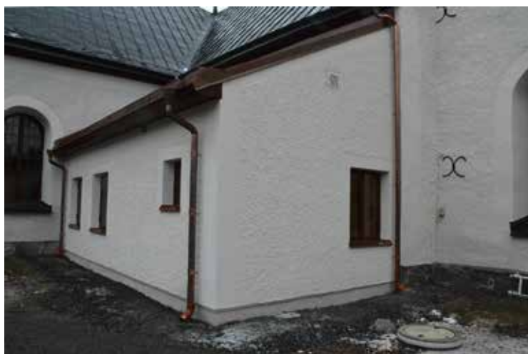
Tillbyggnaden från nordväst. Vid slutbesiktningen var återställandet av marken i anslutning inte klart.
