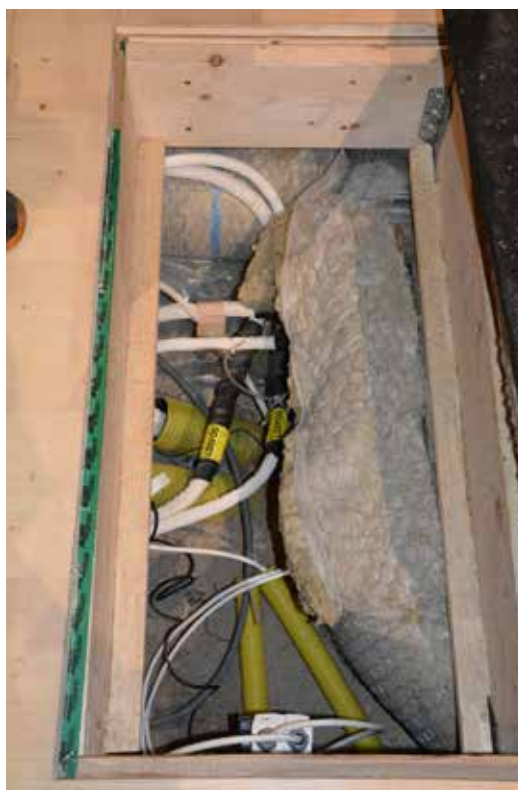
Ingående kablar i anslutning till ett av inomhusaggregaten. Mustätningen diskuterades.
