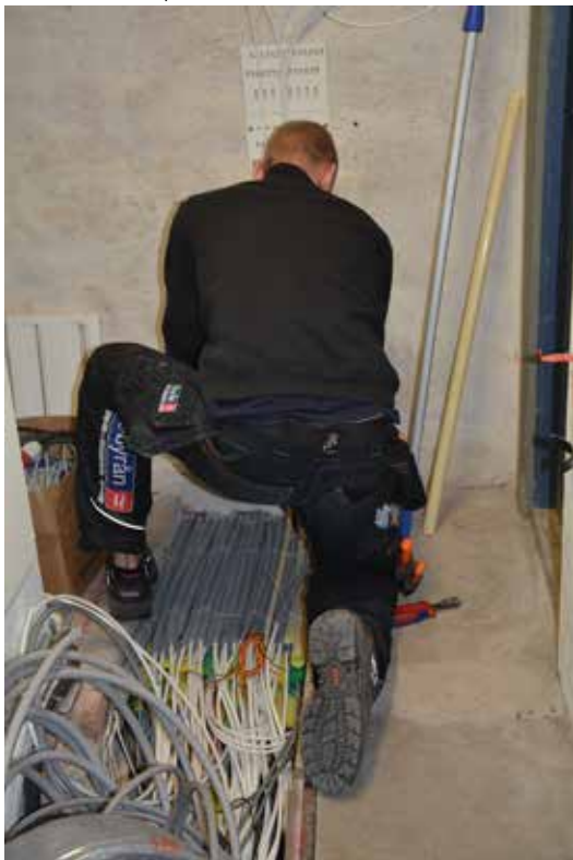
Andreas Karlsson, Elbyrån i Vaggeryd, med alla utgående kablar i golvet i elcentralen.
