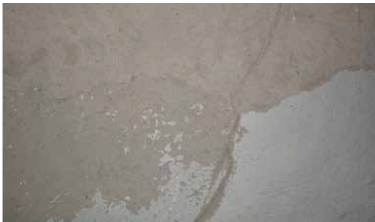
Detalj av väggen i norra korsarmen där putsen släppte i partier.
