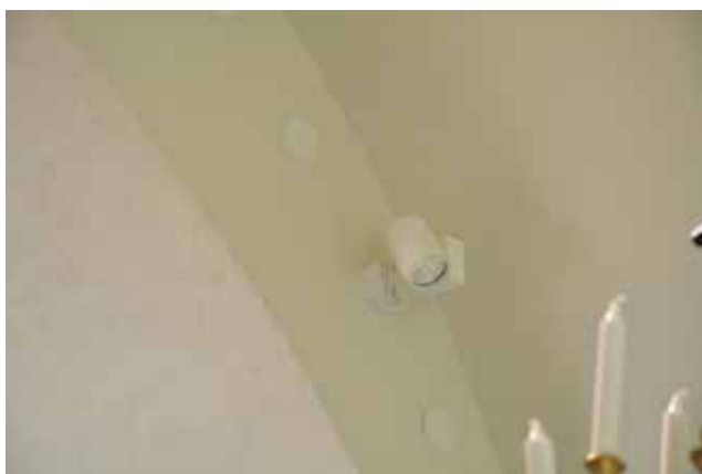
Belysningen i koret, består av spotlights i samma modell som i kyrkorummet. De tidigare uttagen täcktes med doslock.
