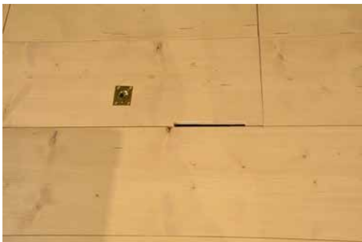
Luckan i korgolvet som bland annat rymmer mikrofonuttag. En liten slits gjordes i kanten av luckan för utgående kablar.
