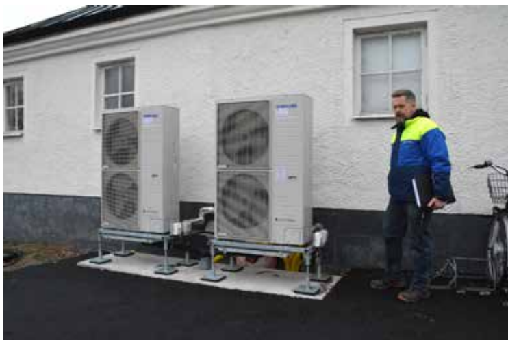
Utomhusaggregaten är placerade vid servicebyggnadens södra fasad.
