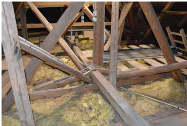
En av lyftarna till takkronorna. Respektive anläggning placerades på nybyggda träbryggor.
