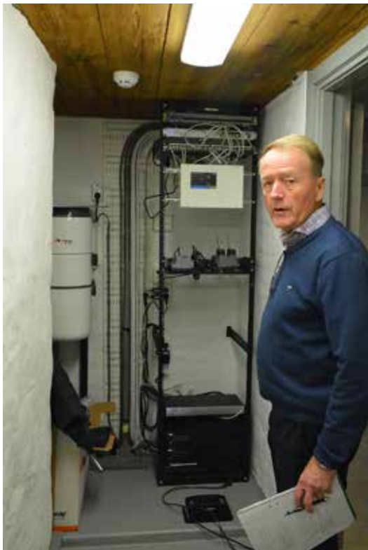
Bernt Sjöland inspekterar installationerna i förrådsbyggnaden, till vänster i bild aggregatet till centraldammsugaren.
