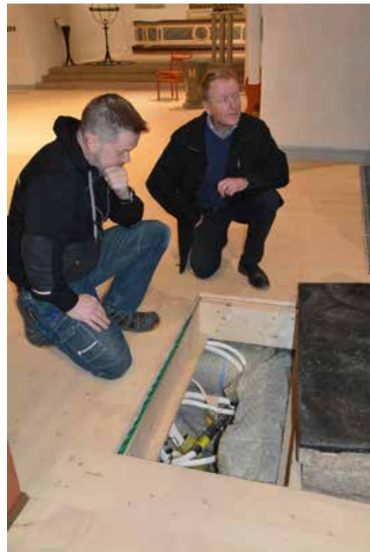
Thomas Hjert och Bert Sjöland inspekterar luftvärmeanläggningen.
