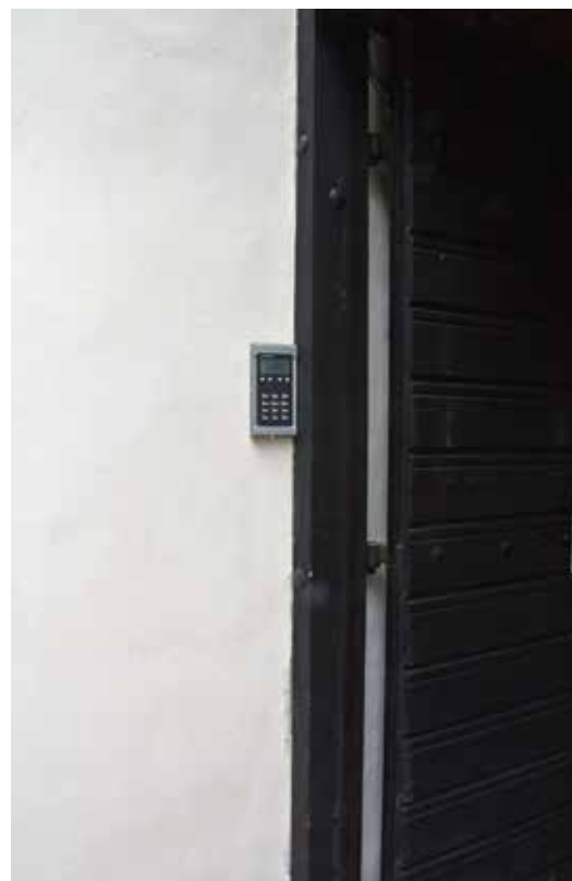
Dosan till larmet var för stor för att rymmas på dörrfodret utan sattes på fasaden i anslutning till porten.
