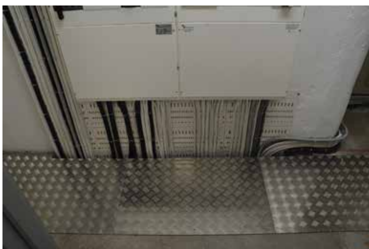
Kabeldragningarna till elskåpet.
