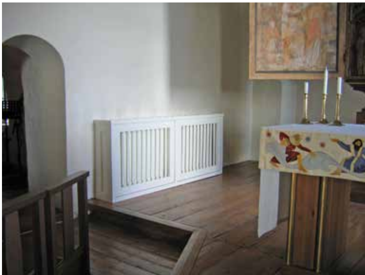
Inbyggd radiator vid korets norra vägg.
