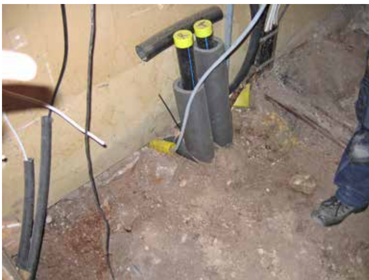
Inkommande rör i förrådet i vapenhuset som byggdes om till apparatrum.
