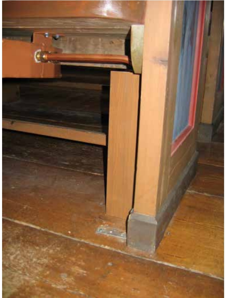
Detaljbild på inklädningen och röranslutningen mot bänkkonvektorn.
