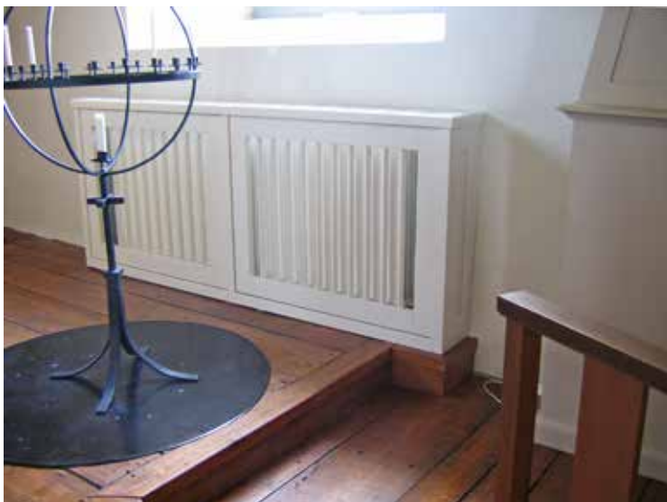
Inbyggd radiator vid korets södra vägg.
