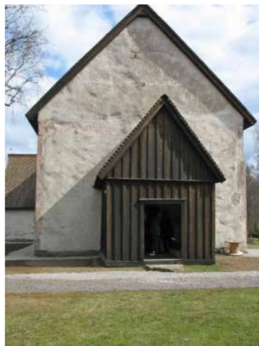
Långhusets västra gavel före åtgärd, avfärgningen var kraftigt urlakad i väggens övre del.
