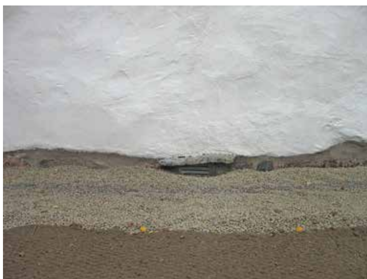
Det påförda materialet gick upp över ventilerna.
