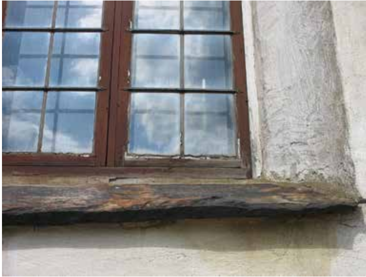
Fönster och solbänk före åtgärd.
