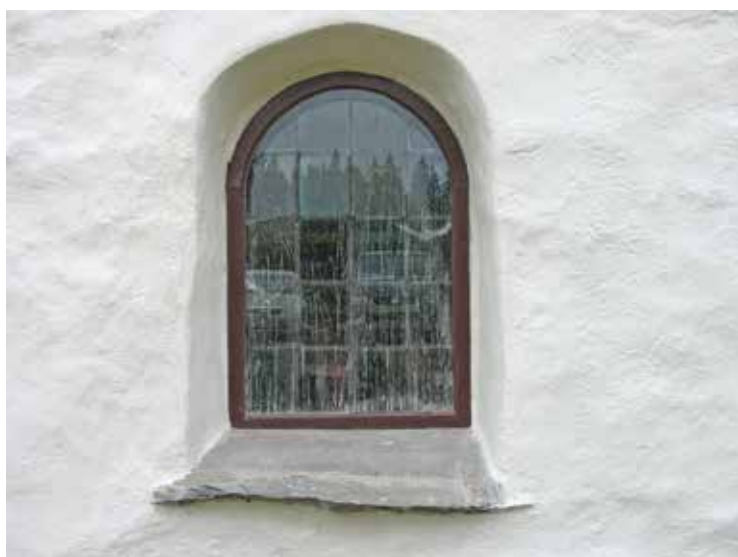
Sakristiefönstret med inträngd blästersand.
