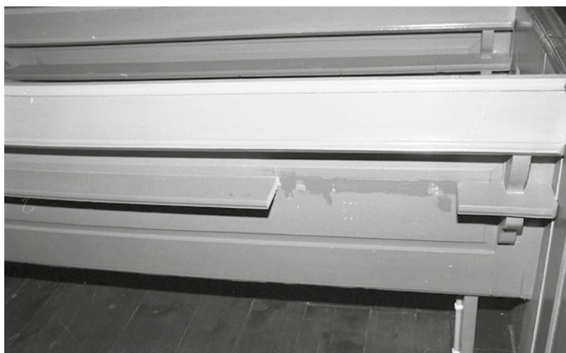
Vid slutbesiktningen var inte psalmbokshyllan där mixerbordet tidigare satt återställd.
