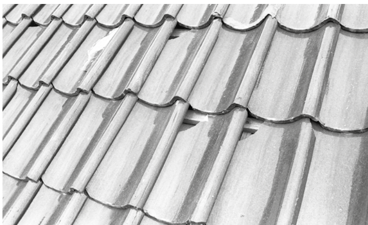
Taket före åtgärd, med de glaserade och delvis skadade tegelpannorna.
