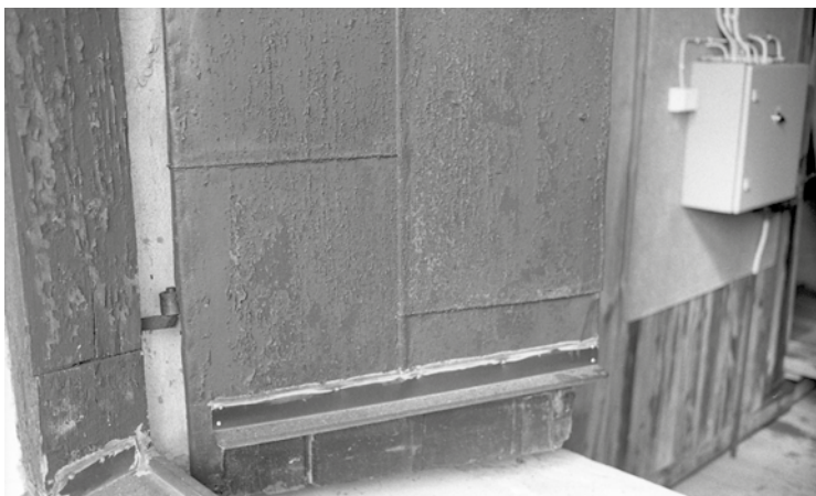
En av tornluckorna före åtgärd.
