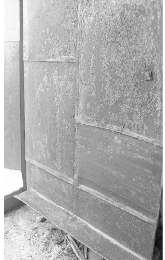
En av tornluckorna före åtgärd, vissa plåtar var sedan tidigare bytta.
