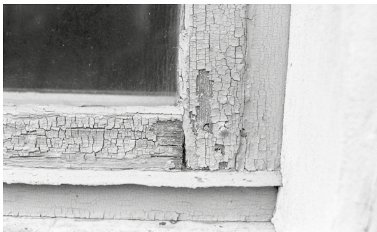
Ett av fönstren före åtgärd där man ser hur färgen krackelerar.
