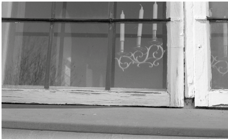
Ett av fönstren före åtgärd.
