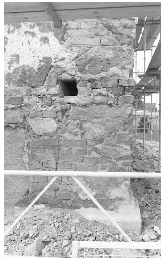
Murverket med omväxlande sten och tegel, vidare är teglet inte konsekvent murat i förband.
