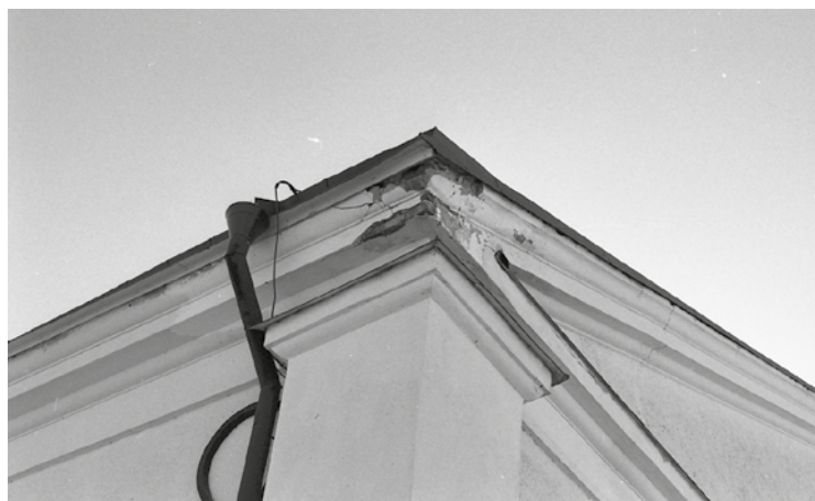
Skador på gesimsen före åtgärd.
