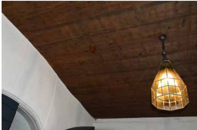
Detektorn och ledningsdragningen i taket i vapenhuset, målad mot underlaget.
