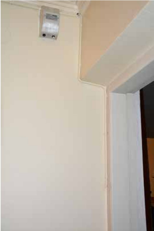
Kabeldragningen på toaletten till larmdosan i kyrkorummet.
