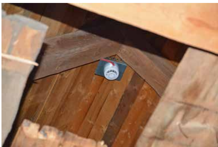
En av detektorerna i taket på vinden.
