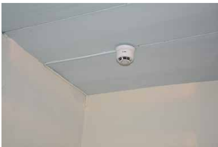
Inmålad detektor i taket i ett av rummen under läktaren.
