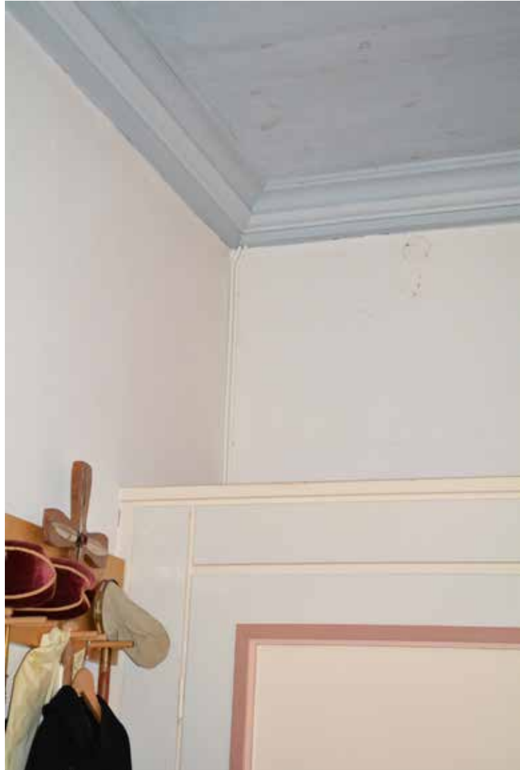
I sakristian behövde kabeln dras synligt från skåpet upp till taket. Det inmålade röret är diskret placerat och inget som stör blicken.
