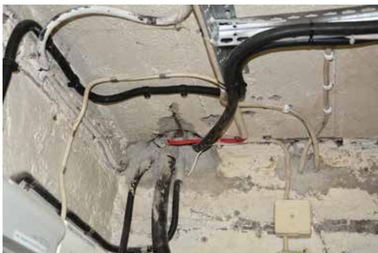
Genomföring av kabeln genom källartaket. Den röda brandkabeln ligger i VP-rör fram till väggen.
