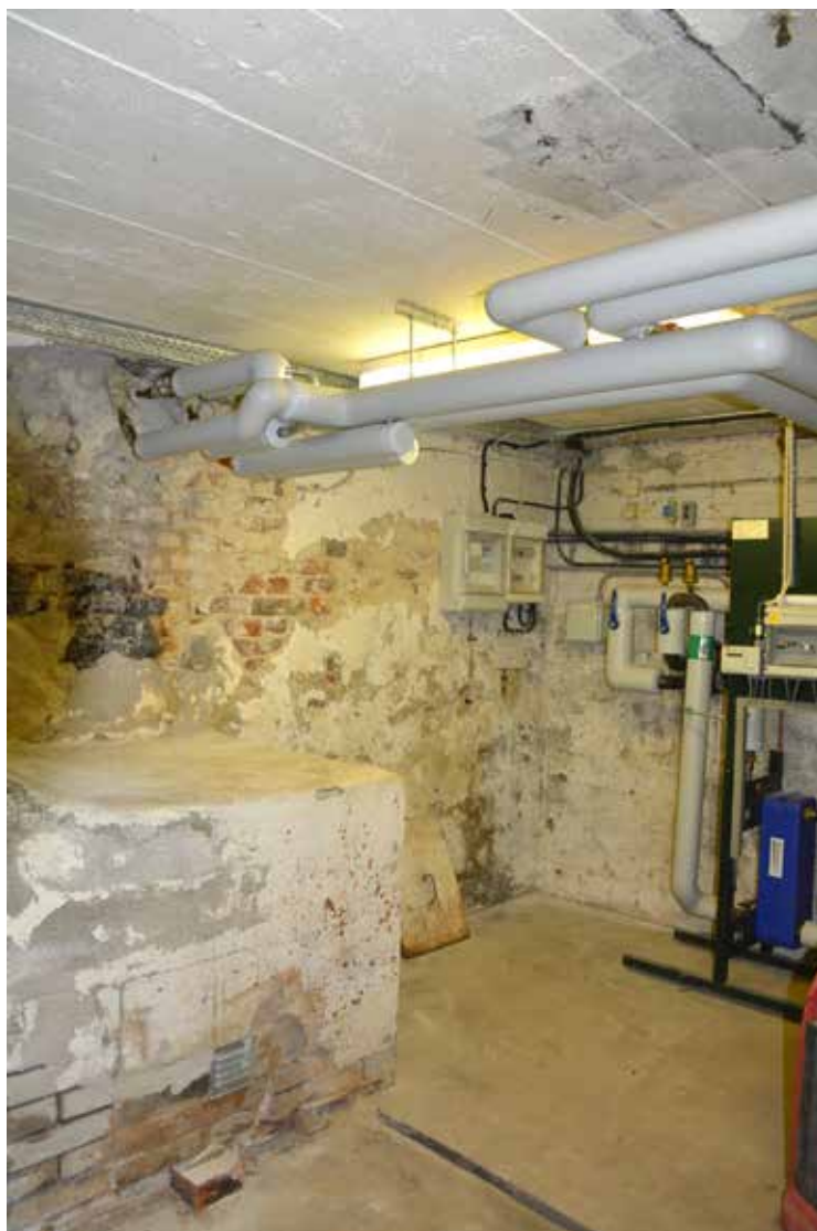
Brandcentralen placerades i det gamla pannrummet som nyttjas för en rad installationer.
