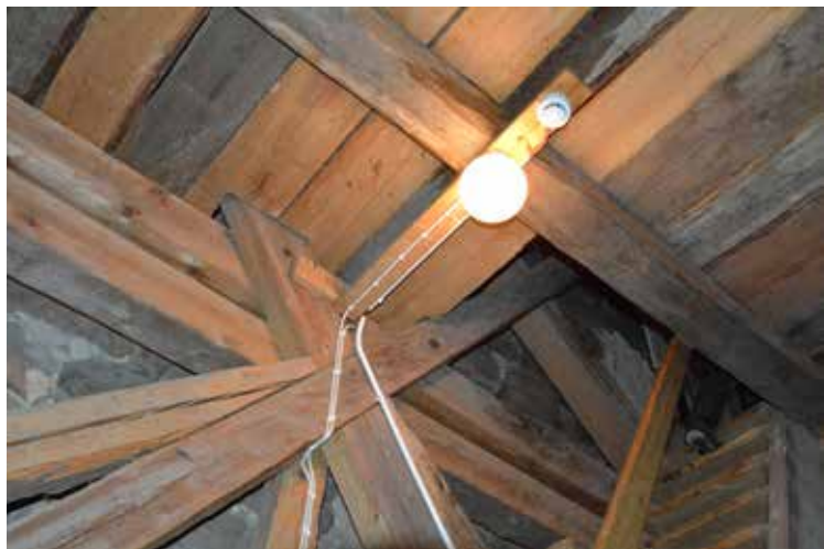
Detektorn i tornets första plan, monterad i anslutning till övriga installationer.
