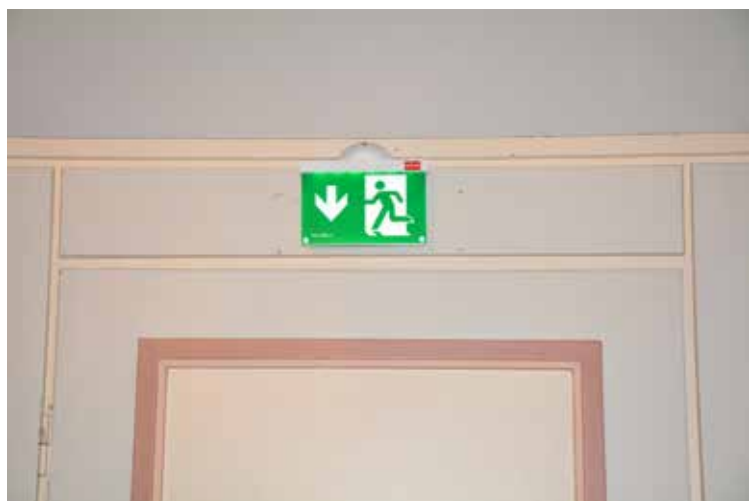
Utrymningsskylt i sakristian.
