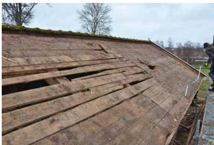
Södra takfallet från väster. Taket hade flera skador och visade spår efter olika lagningar över tid.
