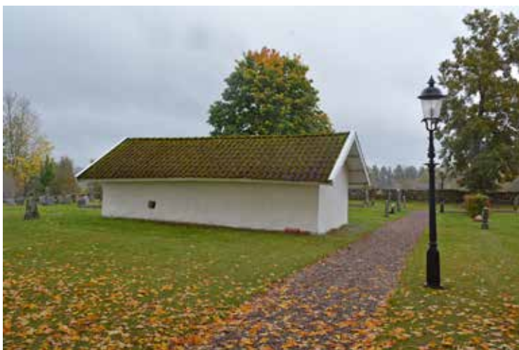
Gravkoret före åtgärd. Foto från norr, notera hur takfallet svackar i dess östra del.
