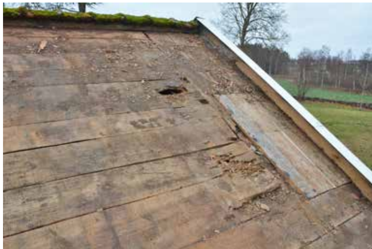
Skador södra takfallet, åt öster.
