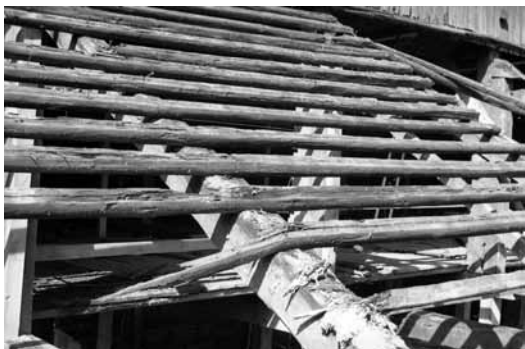
Ovan: Typiska rötskador i sammanfogning av bjälke, taksparre och syll på östra stenmuren samt på takreglarna.
