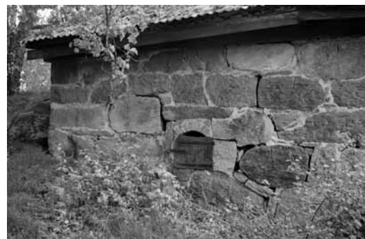
Nedan: Dynamitkällare i norra delen av byggnaden samt parti av byggnaden mot öster med kraftigt nedböjt tak. 19 maj 2004.
