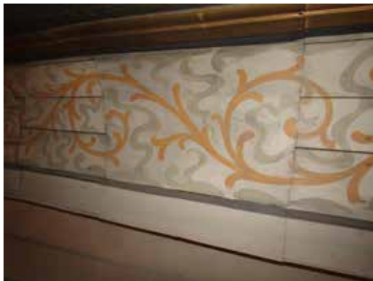
Här på den södra taklisten finns en plåt som täcker den öppning som fanns för en kamins rökgång.
