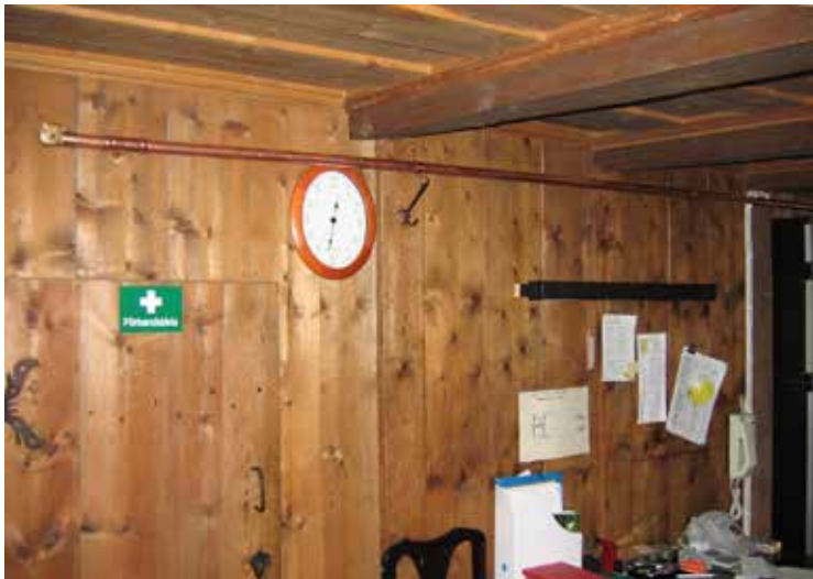
Synlig rördragning i sakristian.
