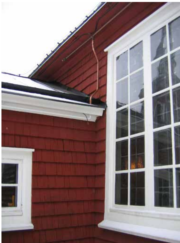
Installationen på långhusets norra sida och norra vapenhuset.
