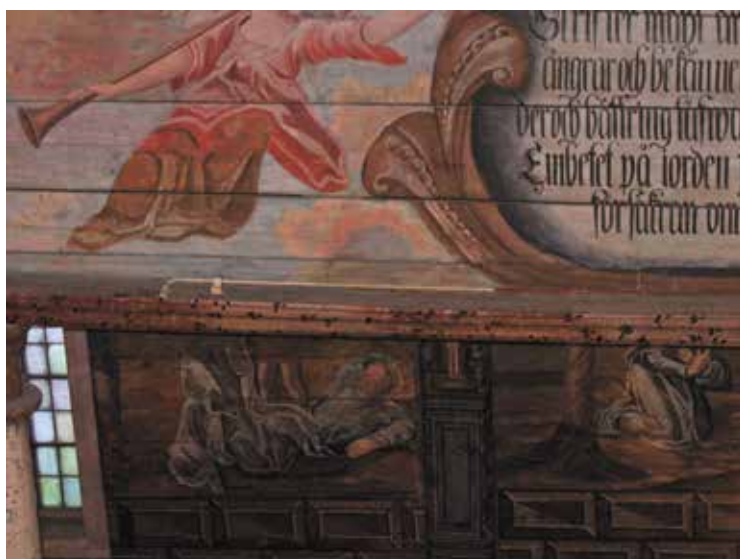
Inmålat sprinklerrör på läktarkanten.
