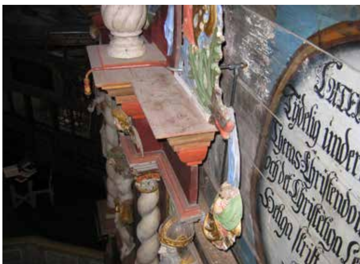
Sprinkler vid altaret.
