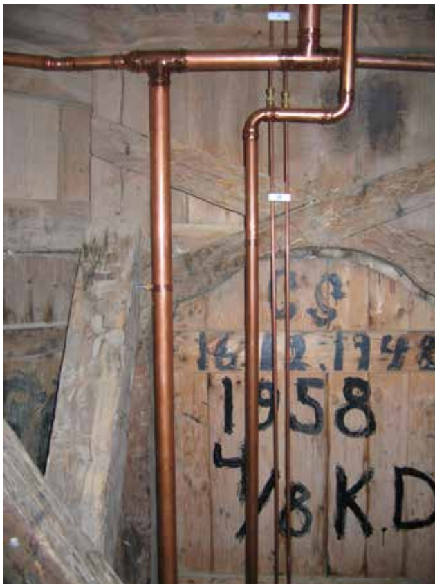
Delar av installationen i tornet.
