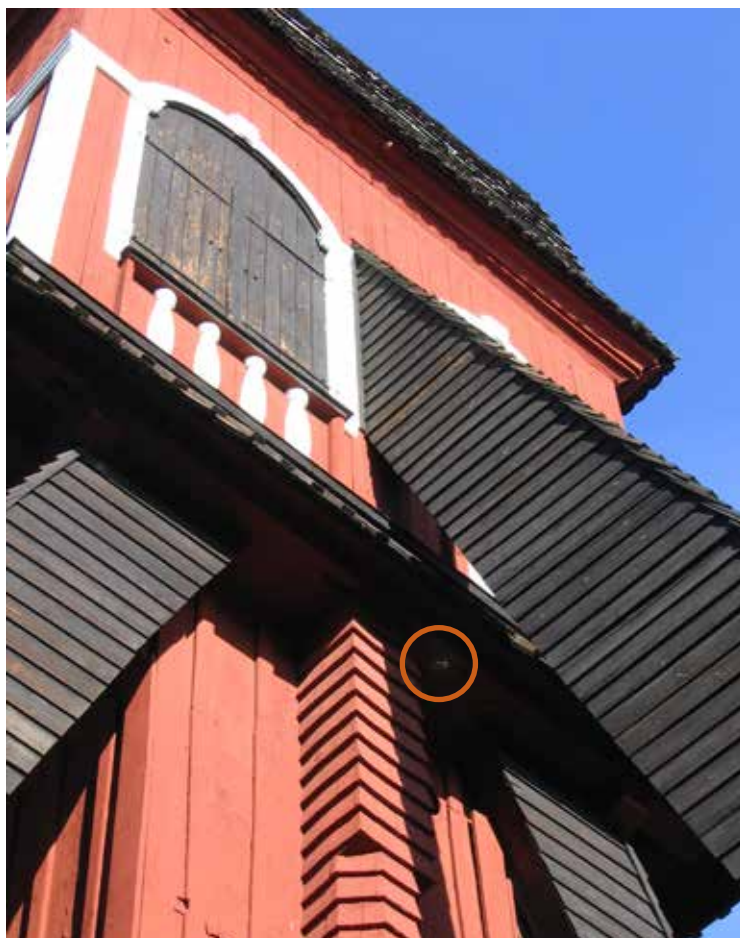
En av de monterade sprinklerna på klockstapeln.
