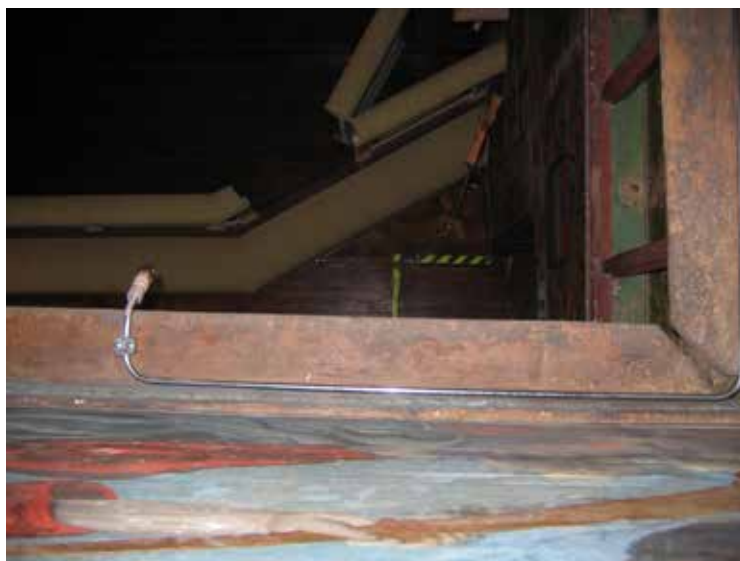
Rördragning på läktarkanten med utstickande sprinklerhuvud.
