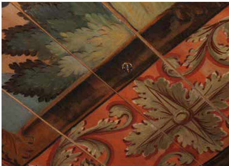
Ett av sprinklerhuvudena i taket.
