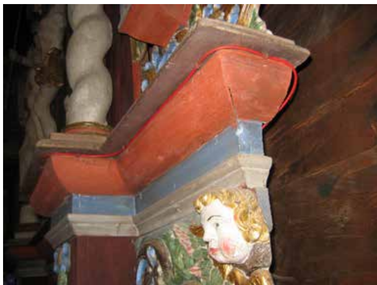
Den monterade värmekabeln på altaret.
