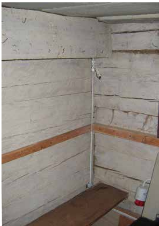
Sprinklern efter inmålning i en av läktarbalkongerna.
