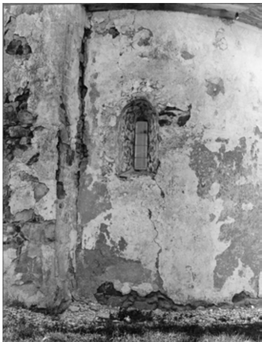
Södra absidfönstret med framtagen renässansdekor 1938. Här syns även omfattningen av skador i den underliggande putsen efter friläggandet. Foto: Sven Wahlgren 1938, ATA.
