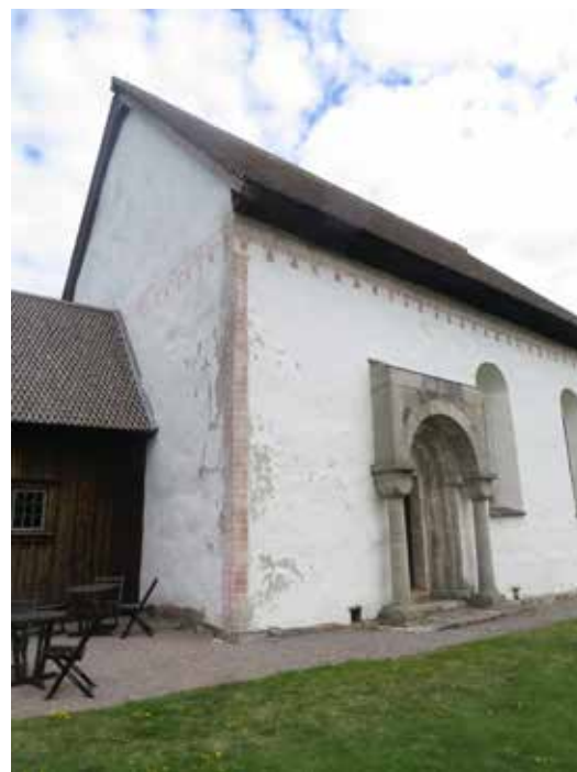
Putsskador i anslutning till långhusets sydvästra hörn 2022.
