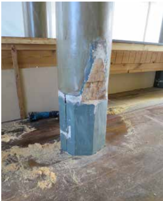
De frilagda kolonnbaserna uppvisade bitvis skador efter att ha varit integrerade i bänkinredningen.
