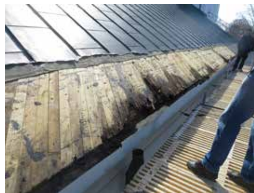
Efter avrivning av plåten kunde konstateras att läckagen hade orsakat skador på den underliggande taksvallen.
