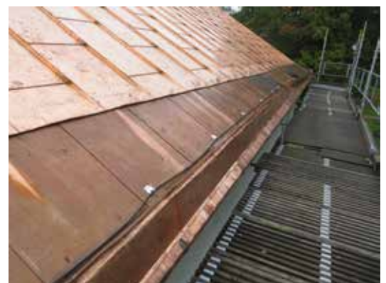
Takavvattningen har försetts med en frostvakt. Värmekabeln ligger löst i fotrännan och vidare ned i stuprören.
