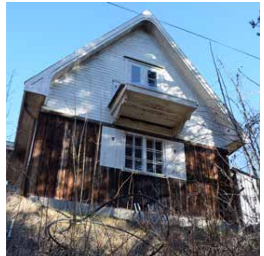
Den sydvästra gaveln före åtgärd. Gavelröstena är klädda med en liggande spontpanel, vilken var i behov av ommålning.
