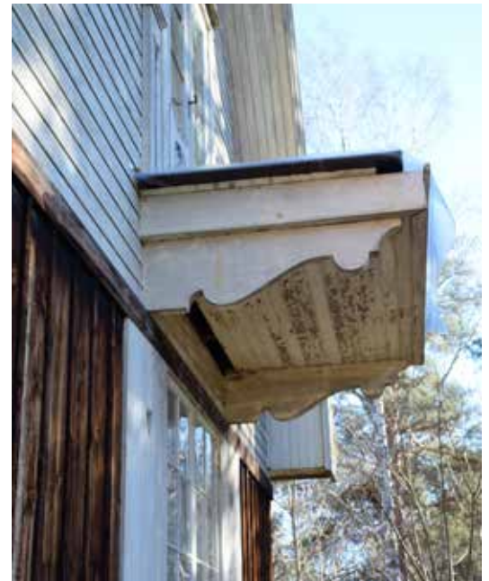
Balkongen vid den sydvästra gaveln. Räcket var rötskadat och det läckte genom balkongplattan.
